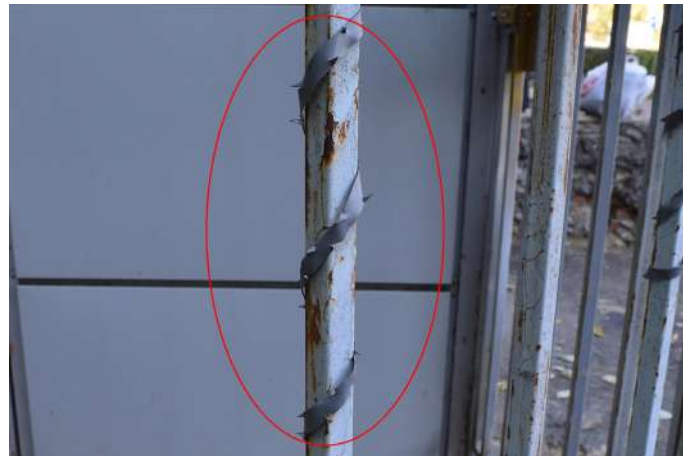
травмоопасные конструкции (колючая проволока на ограждении НТО)
