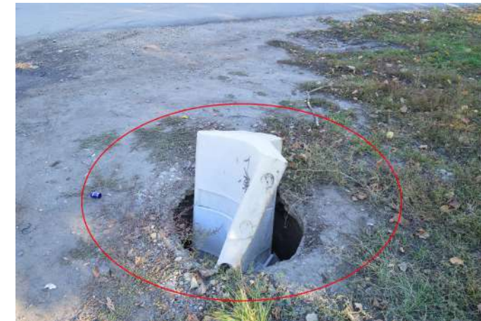
открытый канализационный люк
