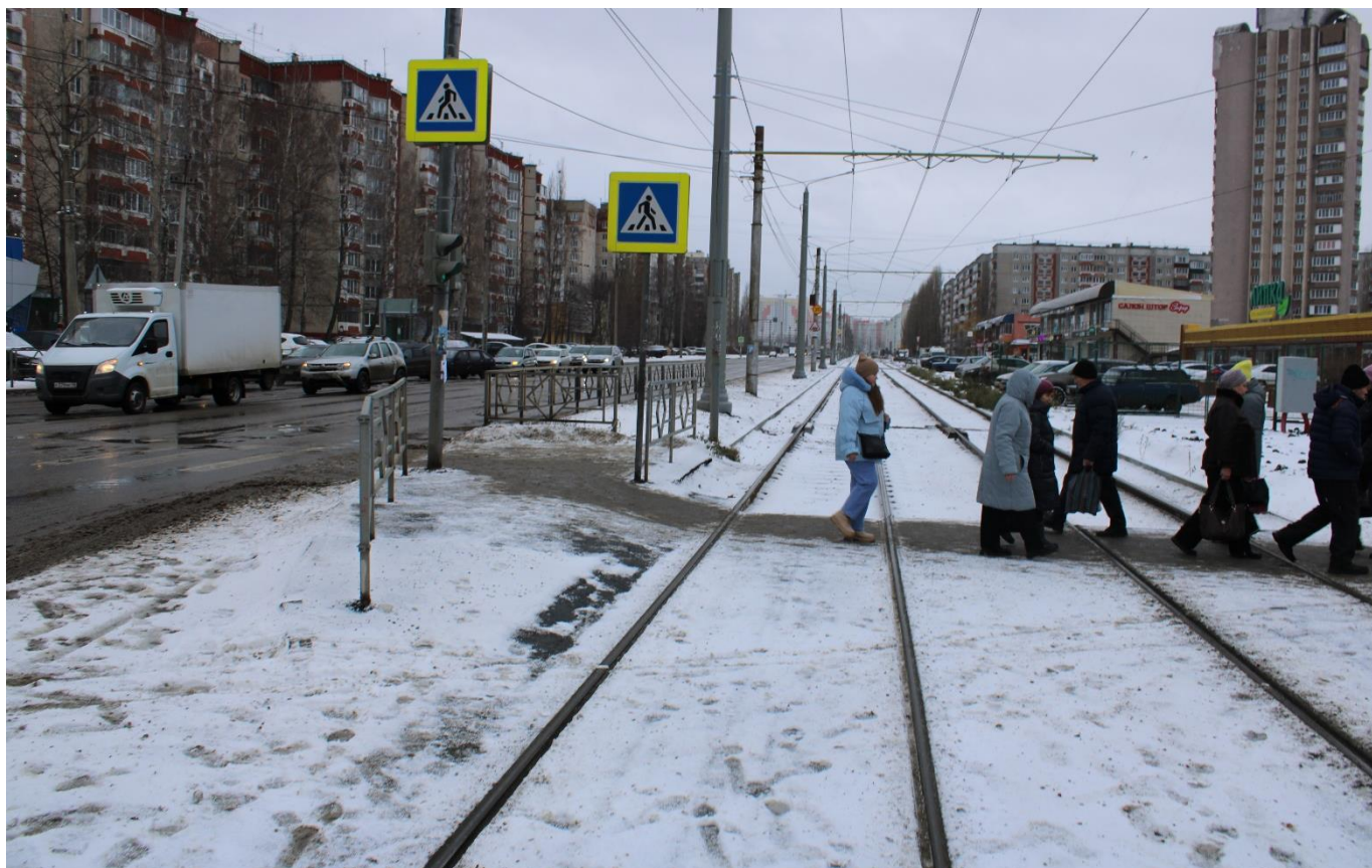
Рис. 39. Пересечение пр. 60 лет СССР и ул. Меркулова. Необходимо переустройство асфальтового покрытия пешеходного перехода во избежание повреждения нижних частей вагона в зимнее время
