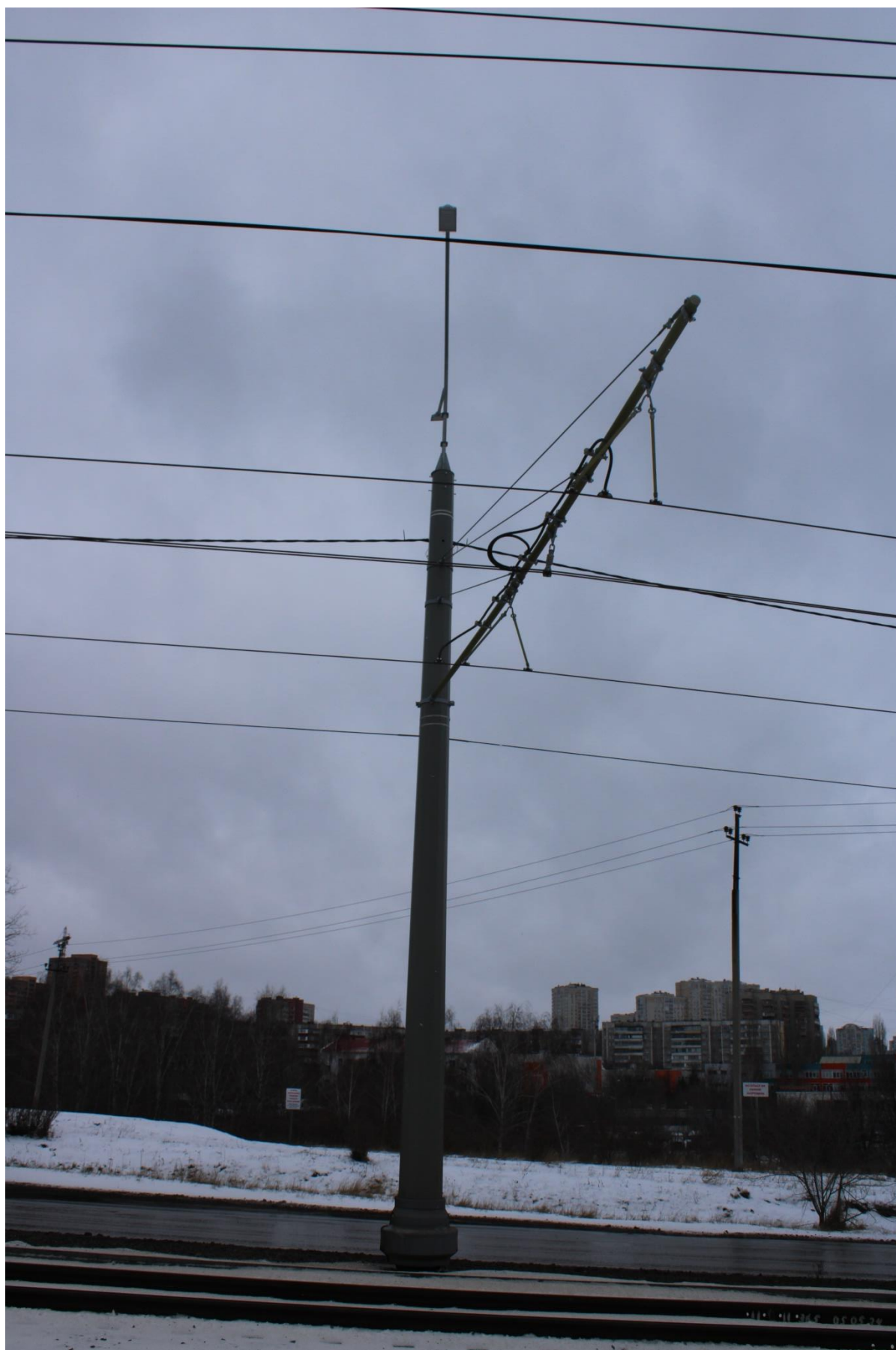
Рис. 45. Участок пути по ул. Полиграфическая. Смещение кронштейна и контактного провода на трёх опорах на кривом участке пути в районе парка Победы.
