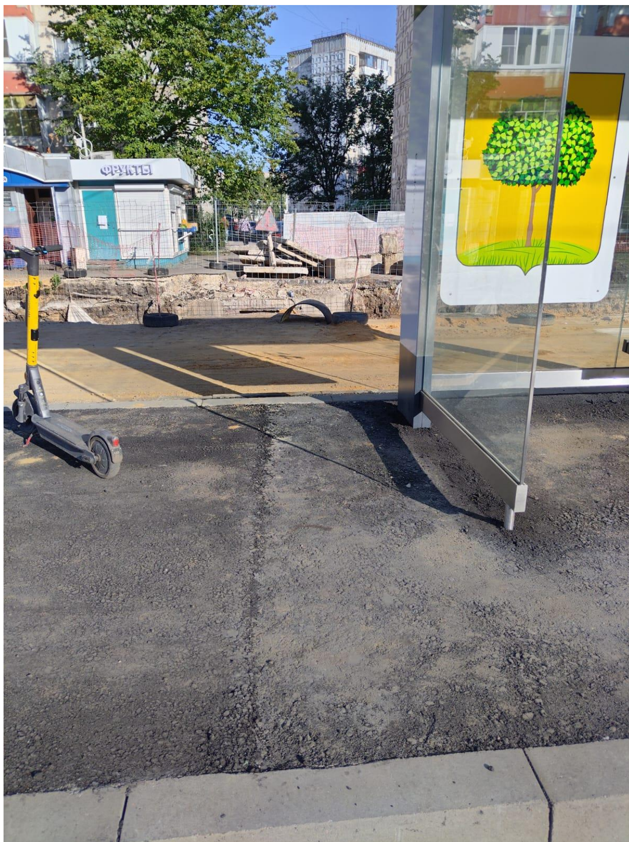
Рис. 42. Остановочный пункт «ул. Катукова» в сторону 21 микрорайона. Асфальтовое покрытие уложено в уровень с бортовым камнем со швами и неровностями. Необходимо осуществить работы по асфальтированию посадочных площадок в соответствии с требованиями СП 78.13330.2012
