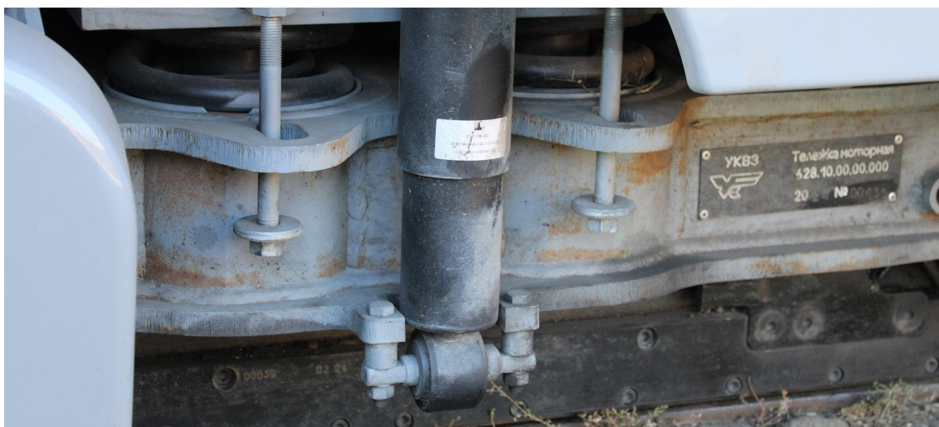
Рис.1. Коррозия моторной тележки.
