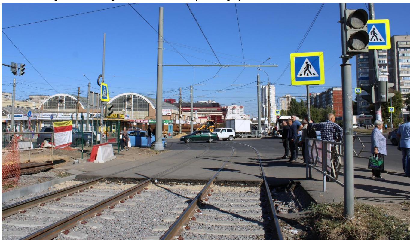
Рис. 38. Пересечение пр. 60 лет СССР и ул. Меркулова. Необходимо переустройство асфальтового покрытия пешеходного перехода во избежание повреждения нижних частей вагона в зимнее время
