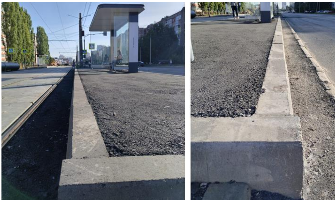
Рис. 44. Остановочные пункты «ул. Катукова». Смещения при укладке бортовых камней. Бортовые камни должны повторять проектный профиль покрытия. Уступы в стыках бортовых камней в плане и профиле не допускаются согласно п. 6.2.5 СП 82.13330.2016. Ширина швов между бортовыми камнями не должна превышать 5 мм (ВСН 1-94, п. 5.2.8).
