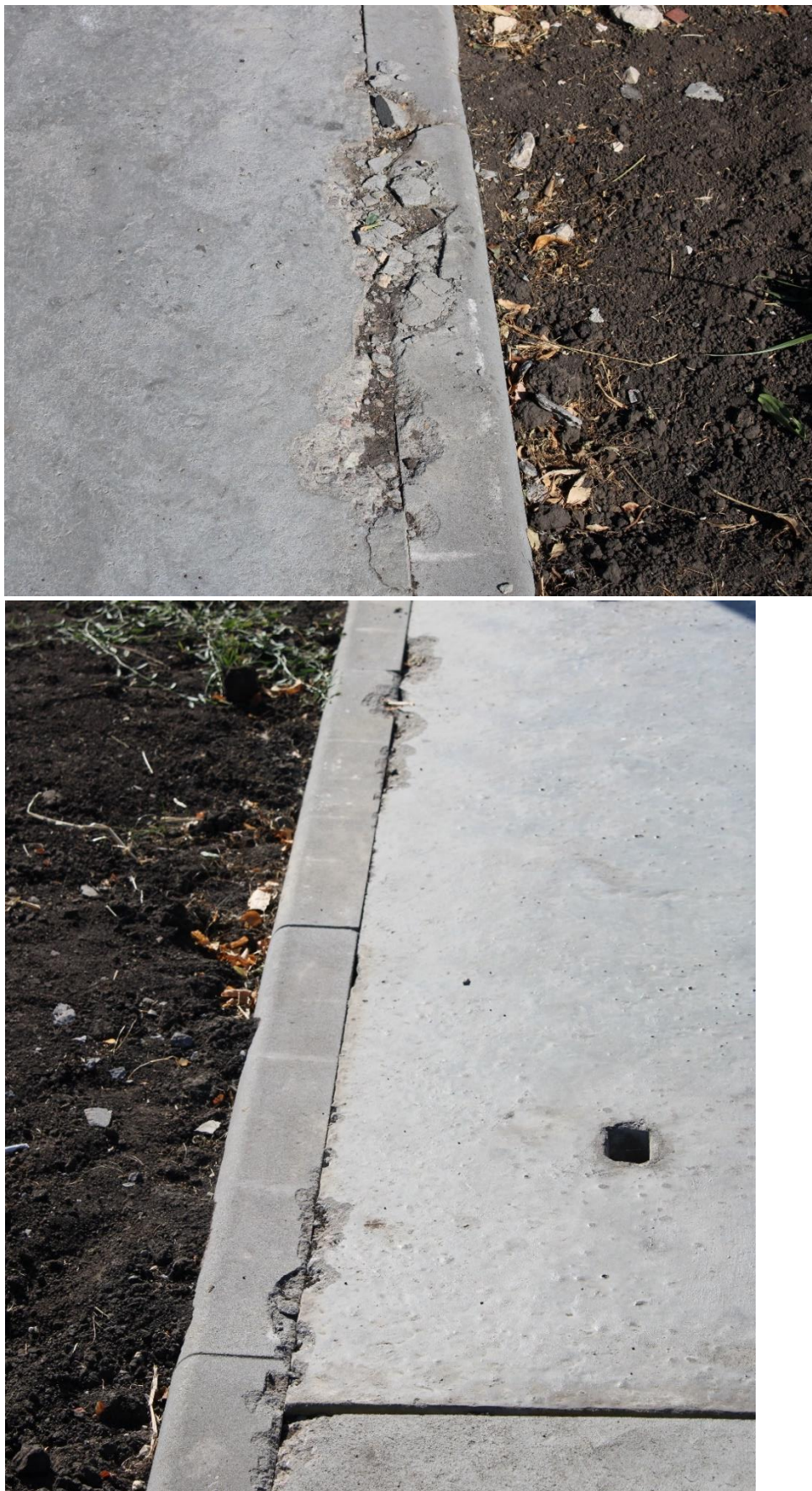
Рис. 47. Повреждение бортового камня и плит в районе остановочного пункта «Парк Победы» на всём протяжении плиточного замощения со стороны входа в парк Победы с ул. Полиграфическая. Необходимо заменить повреждённые элементы
