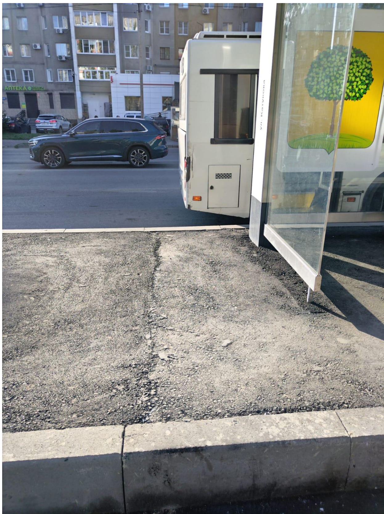
Рис. 43. Остановочный пункт «ул. Катукова» в сторону Октябрьского рынка. Асфальтовое покрытие уложено в уровень с бортовым камнем со швами и неровностями. Необходимо осуществить работы по асфальтированию посадочных площадок в соответствии с требованиями СП 78.13330.2012
