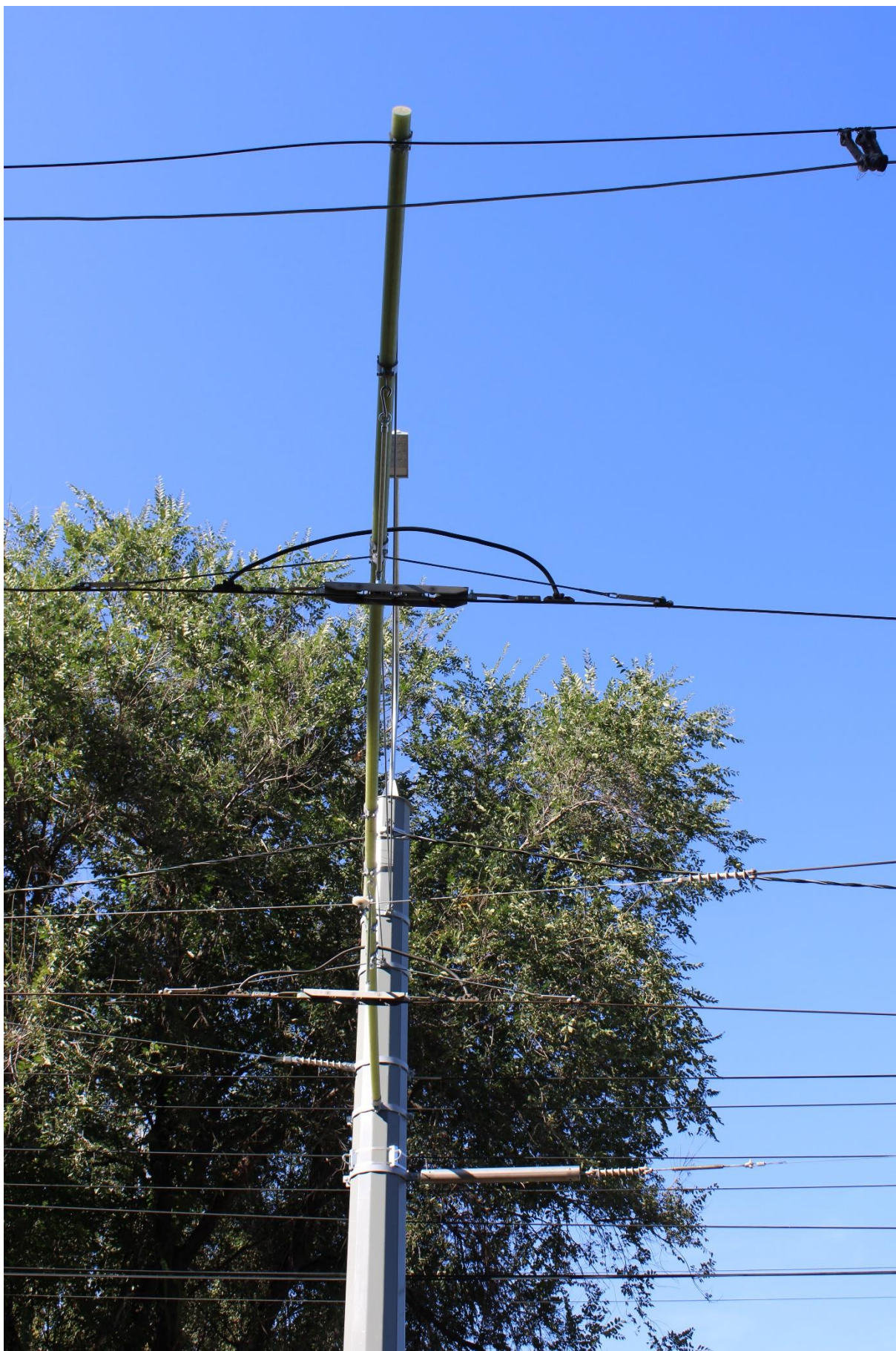
Рис. 79. Необходимо устранить деформацию кронштейна на участке пути в районе АБК трамвайного депо.
