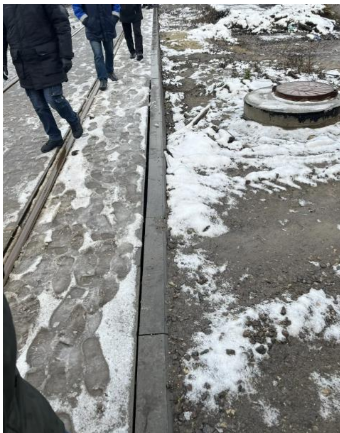
Рис. 93. Остановочный пункт «ул. Речная» неплотное примыкание бортовых камней к краевой плите.
