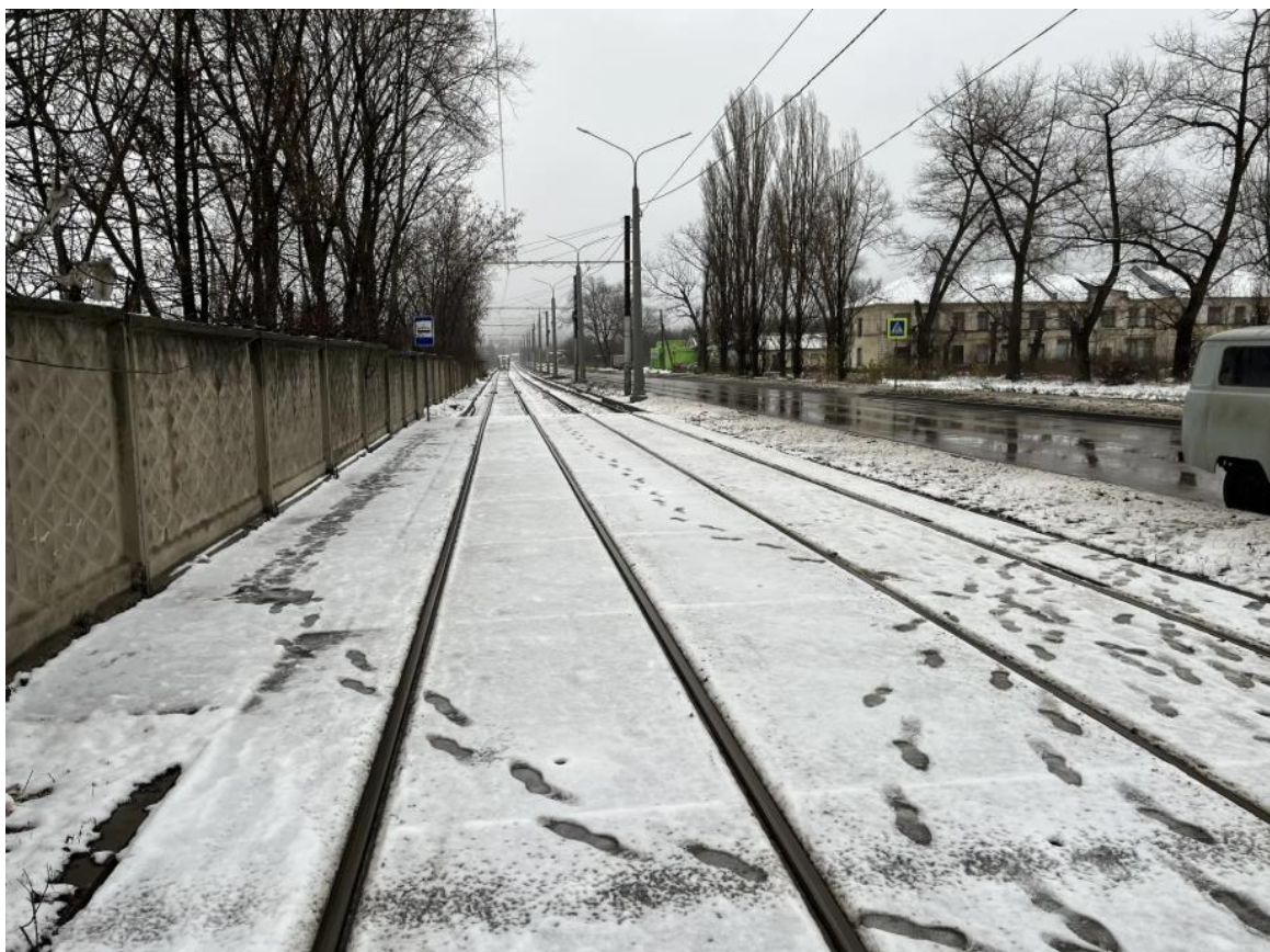
Рис. 19. Остановка «Ул. 3-е Сентября» путь в центр отсутствует остановочный павильон, предусмотренный изначальной проектной документацией.
