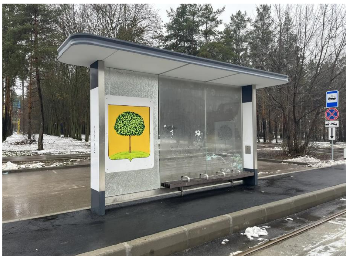
Рис. 57. Переустройство остановочной платформы и перенос павильона на остановочном пункте «Парк Победы». Стеклопанель павильона в сетке трещин.
