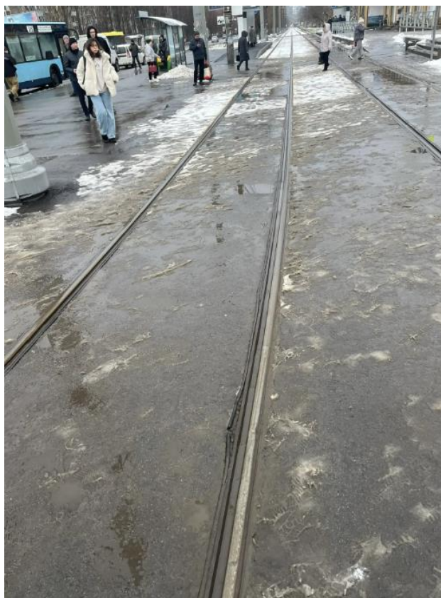
Рис. 46. Неплотное прилегание промежуточного уплотнения между рельсами и асфальтным покрытием остановочный пункт «Октябрьский рынок».
