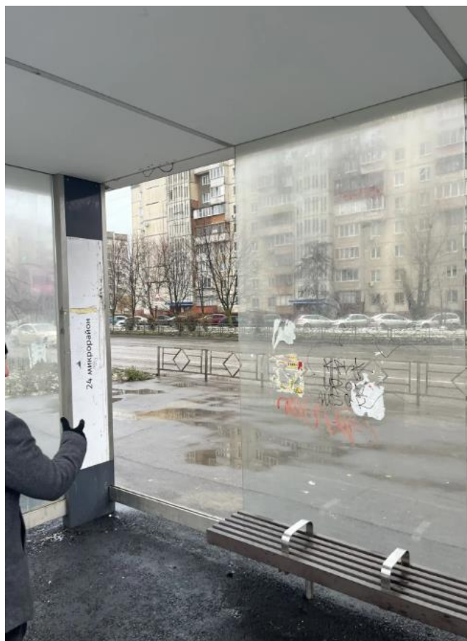
Рис. 54. Остановочный пункт «24 микрорайон». Отсутствует стеклянная стенка.
