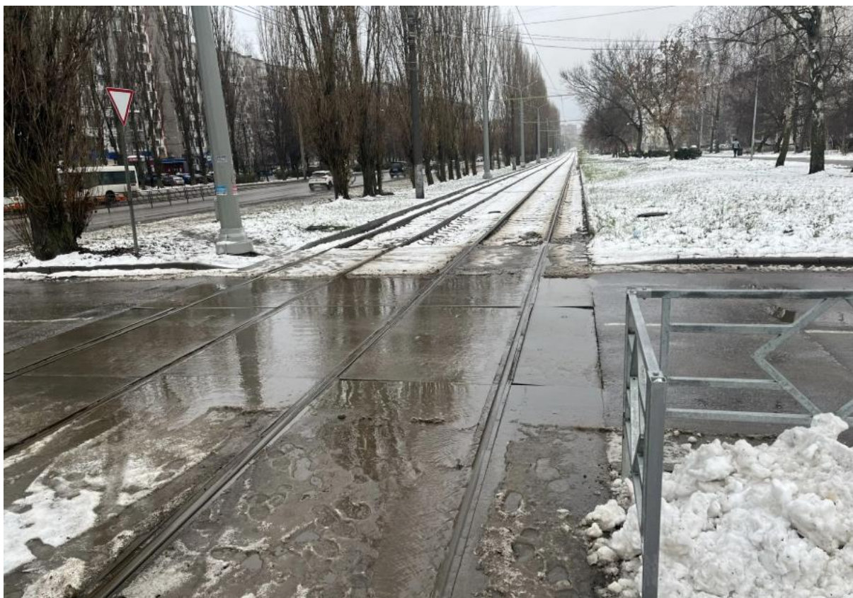
Рис. 48. Просадка плит на пересечении трамвайных путей с автодорогой по ул. Петра Смородина
