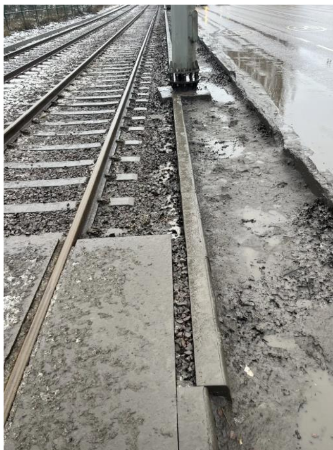
Рис. 92. Остановочный пункт «ул. Речная» примыкание бортового камня выполнено не в соответствии с проектной документацией.
