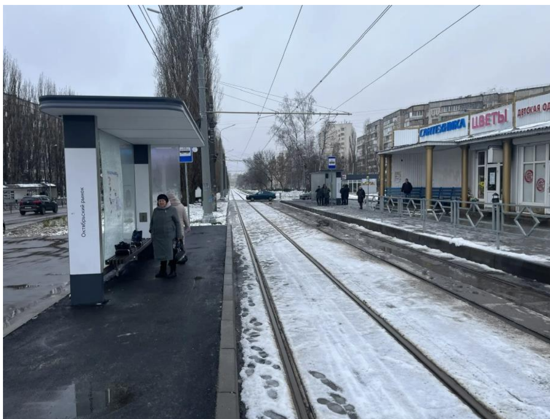
Рис. 47. Стеклопанель остановочного павильона «Октябрьский рынок» в сетке трещин
