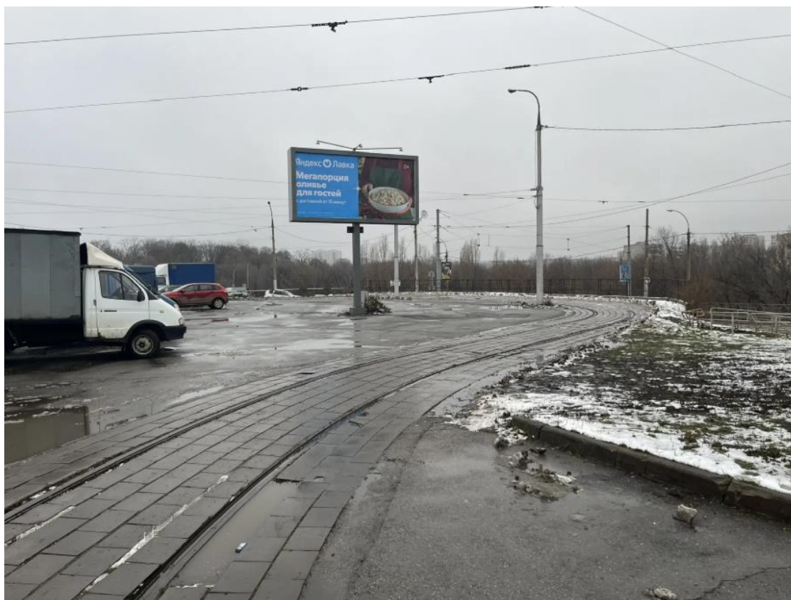
Рис. 74. Демонтаж трамвайного разворотного кольца в районе Центрального рынка на момент проведения Проверки не осуществлён.
