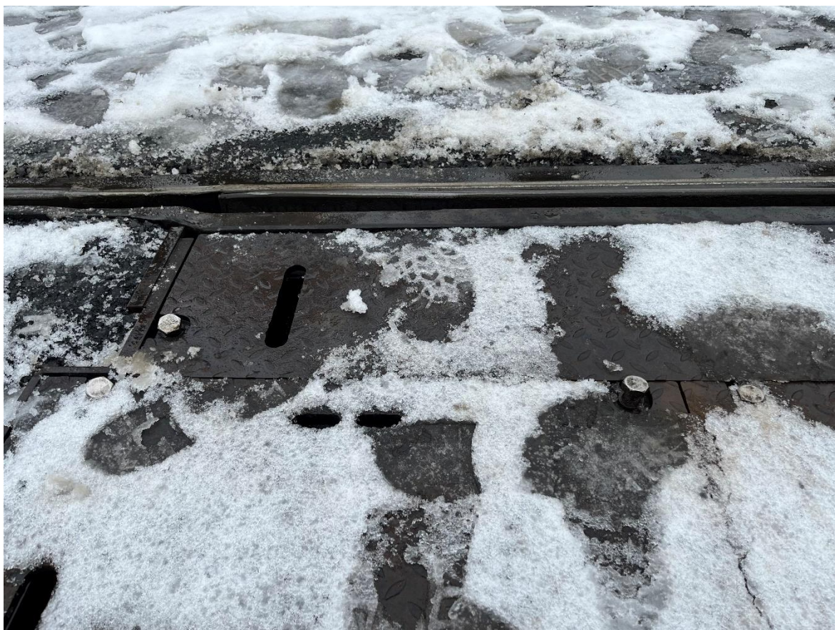
Рис. 15. Улица 3-е Сентября не закреплена крышка стрелочного перевода.
