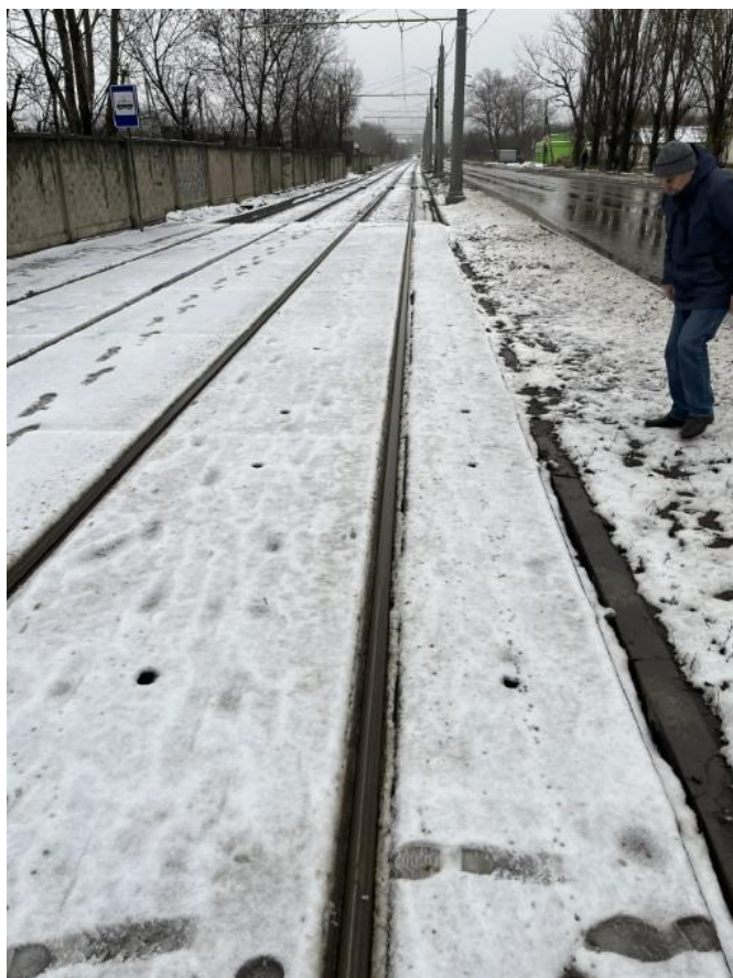
Рис. 21. Неплотное прилегание краевых плит к бордюру на остановочном пункте «3-е Сентября»
