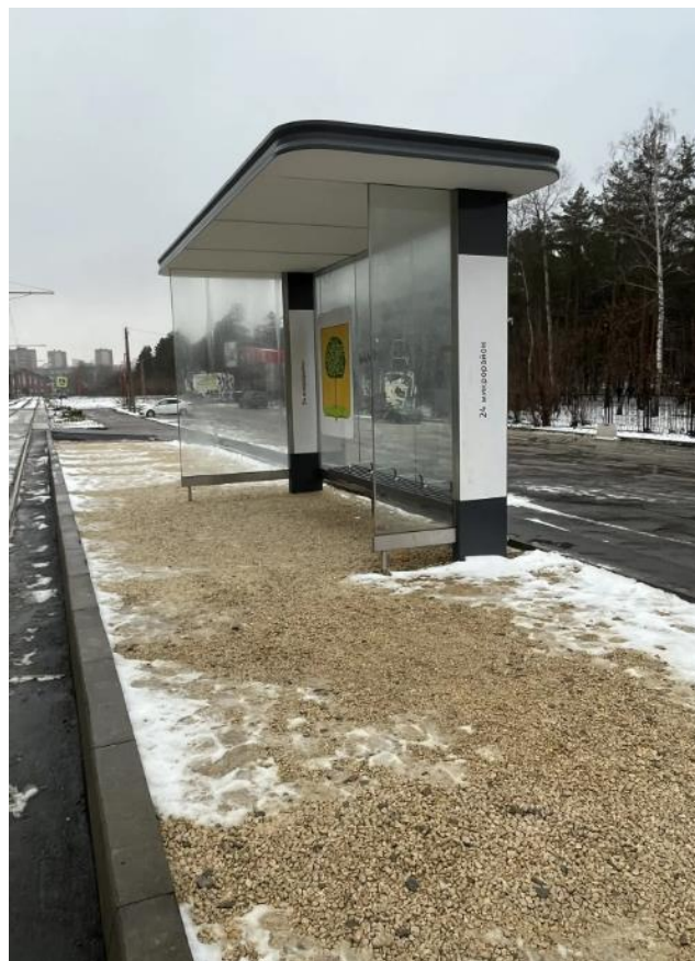
Рис. 53. Остановочный пункт «24 микрорайон». Отсутствует асфальтное покрытие.
