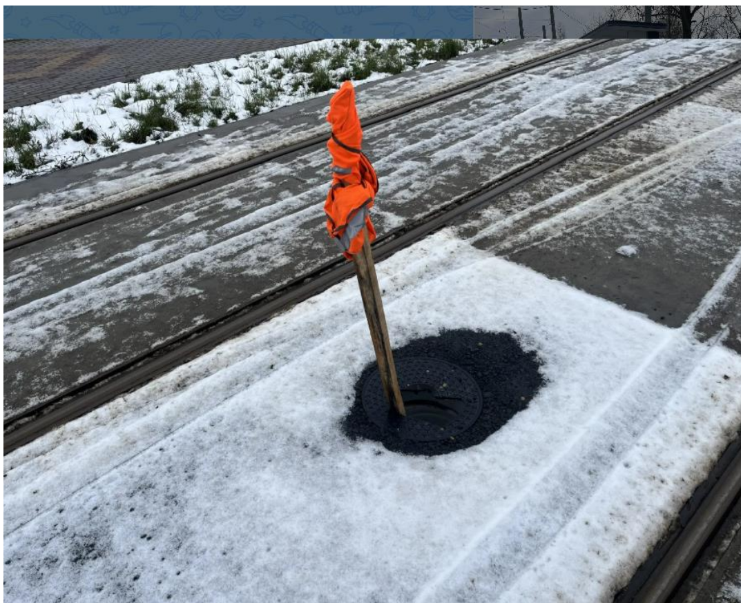
Рис. 55. Остановочный пункт «24 микрорайон» поврежден люк дренажного колодца
