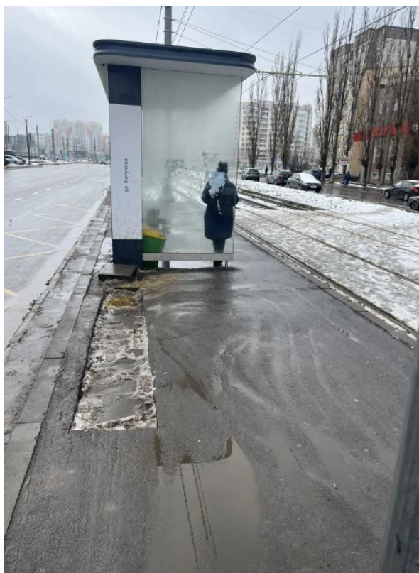
Рис. 44. Остановочный пункт «Улица Катукова». Нарушение целостности асфальтного покрытия.
