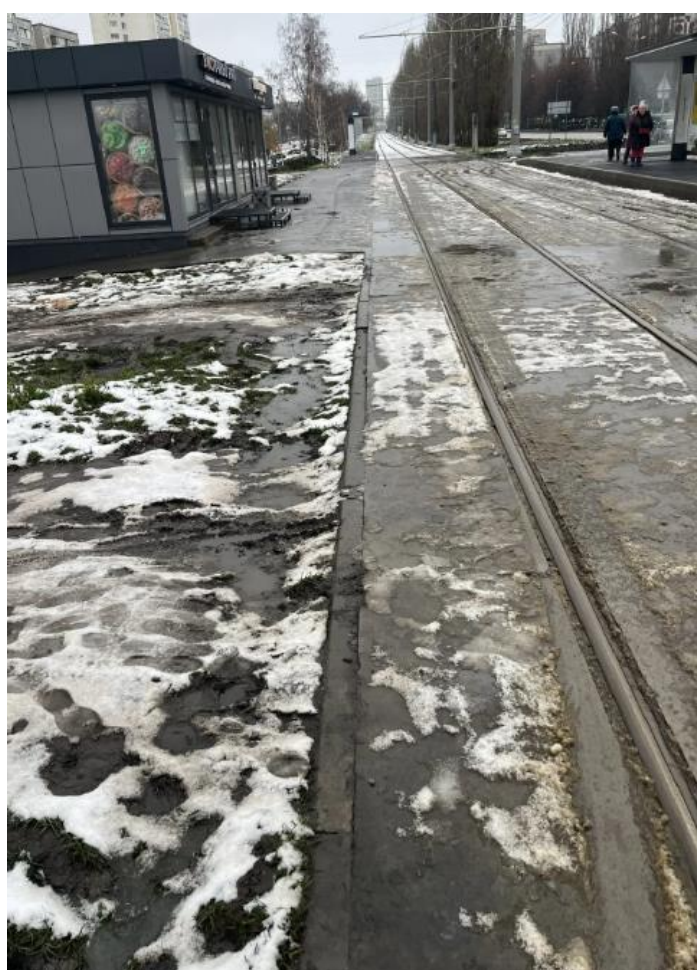
Рис. 51. Просадка бордюрного камня в районе остановочного пункта «Березовая аллея»
