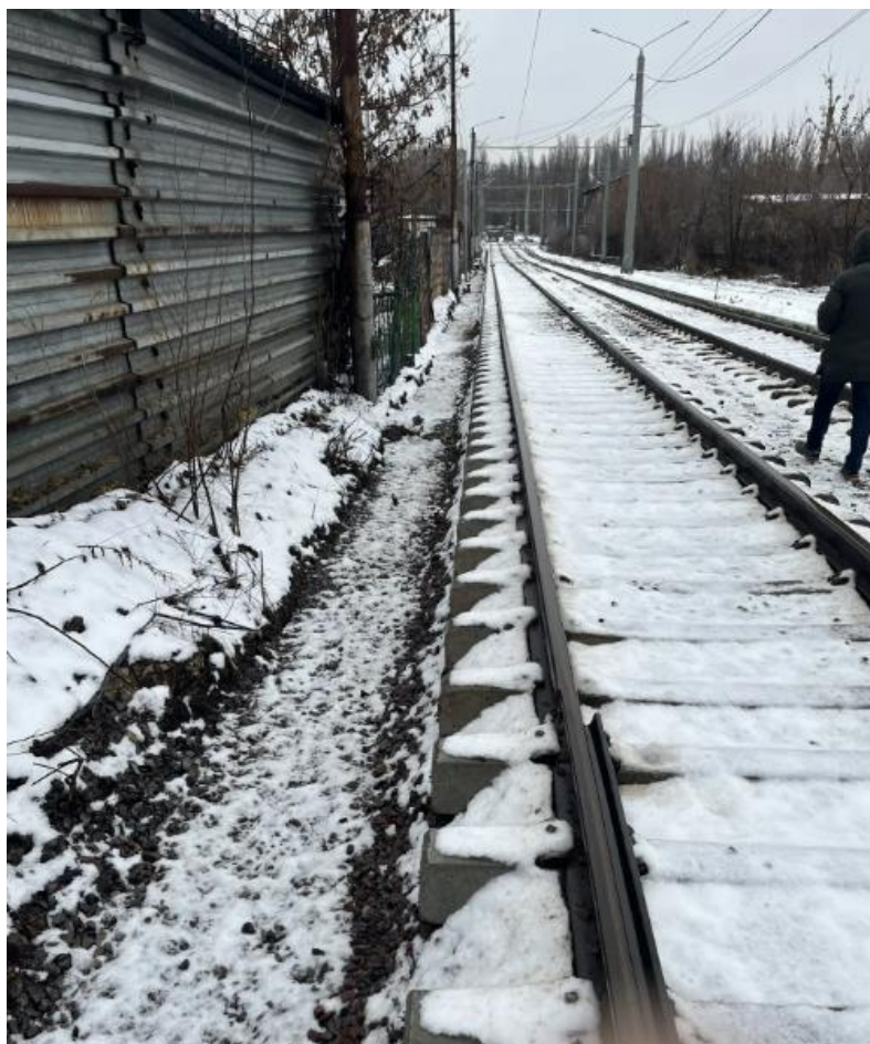
Рис. 62. Трамвайные пути в районе Депо отсутствует балластный слой в торцах шпал
