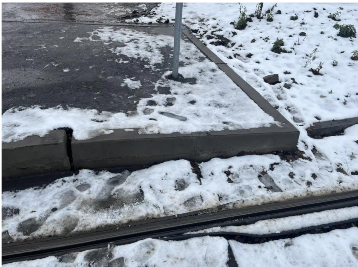
Рис. 42. Просадка грунта в районе посадочной площадки остановочного пункта «21 микрорайон»
