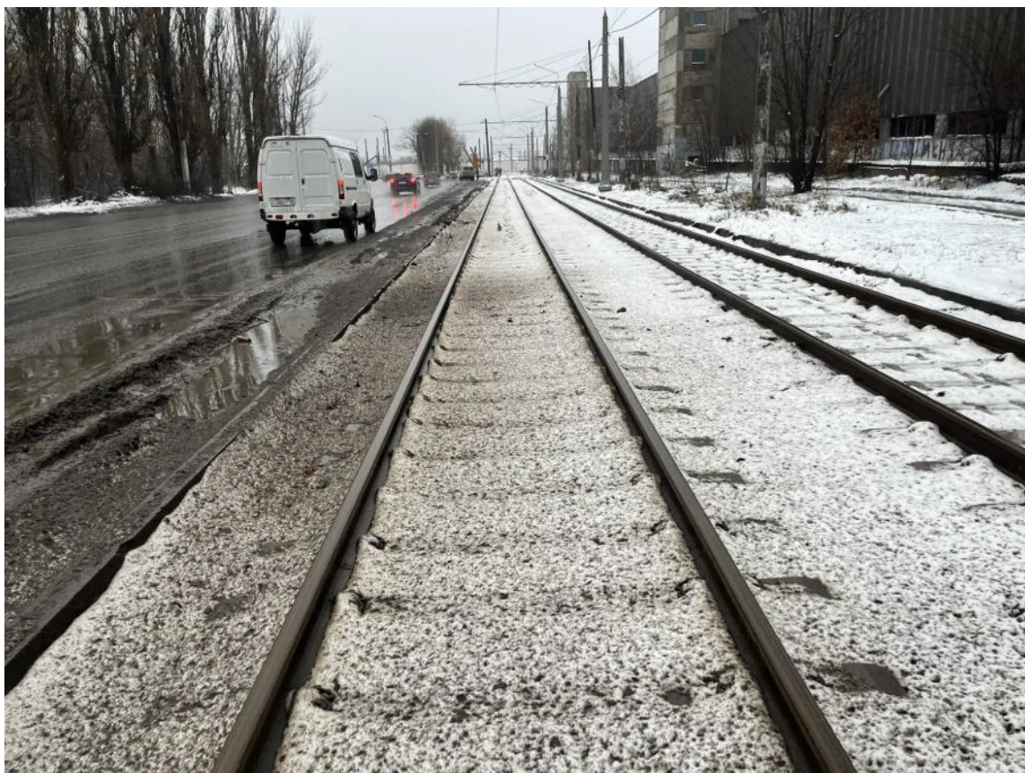
Рис. 29. Засорение балластного слоя открытого трамвайного пути по ул. Краснозаводская
