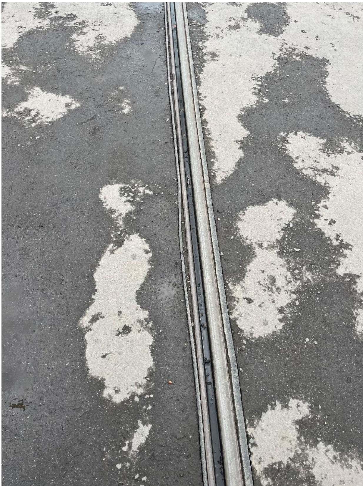
Рис. 54. Неплотное прилегание промежуточного уплотнения между рельсами и асфальтным покрытием остановочный пункт «Октябрьский рынок».
