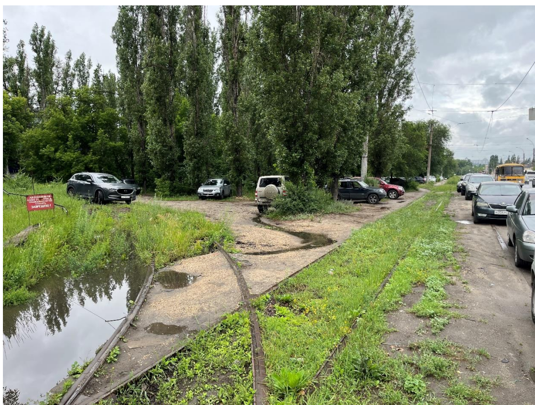
Рис. 92. Разворотный круг по ул. 9 Мая. Демонтажные работы на момент проведения Проверки не начаты.
