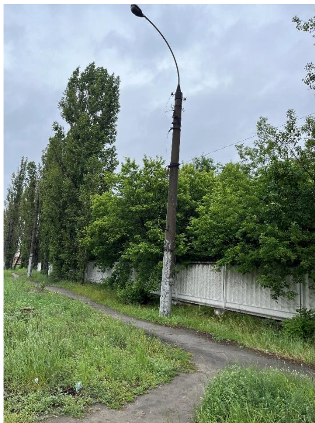
Рис. 89. Ул. Metallургов не в полном объеме демонтированы элементы старой контактной сети
