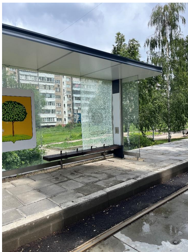
Рис.57. Стеклопанель остановочного павильона «Березовая Аллея» в сетке трещин
