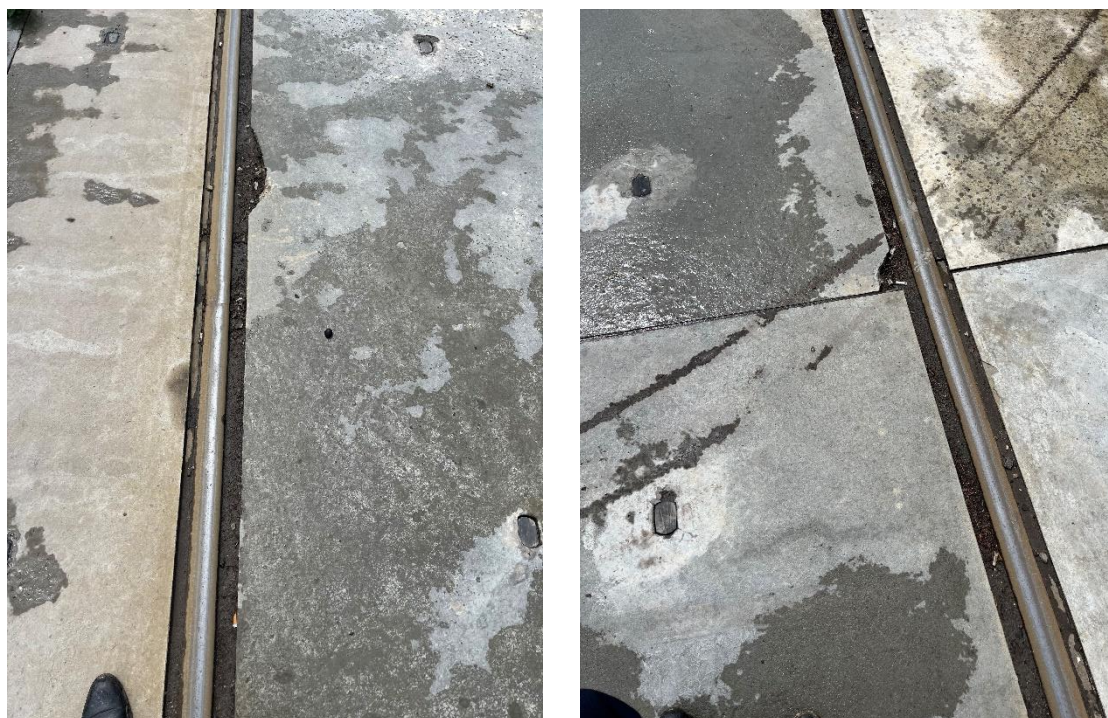
Рис. 50. Повреждение плит, уложенных на остановочном пункте «Улица Катукова»
