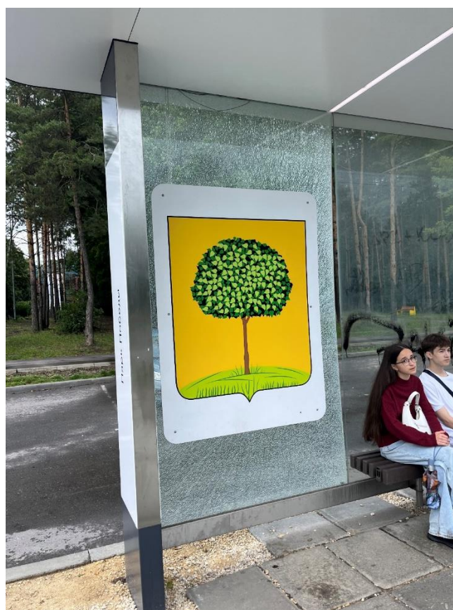
Рис. 60. Остановочный пункт «Парк Победы» в сторону ул. Полиграфическая. Павильон размещён на ненормативном расстоянии от края посадочной площадки. Требуется переустройство со смещением на территорию парковки. Стеклопанель павильона в сетке трещин.
