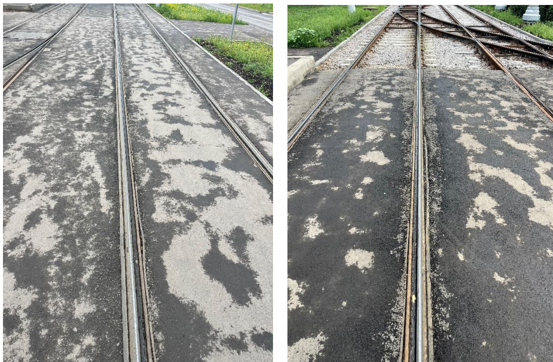
Рис. 48. Неплотное прилегание промежуточного уплотнения между рельсами и асфальтным покрытием остановочный пункт «21 микрорайон».
