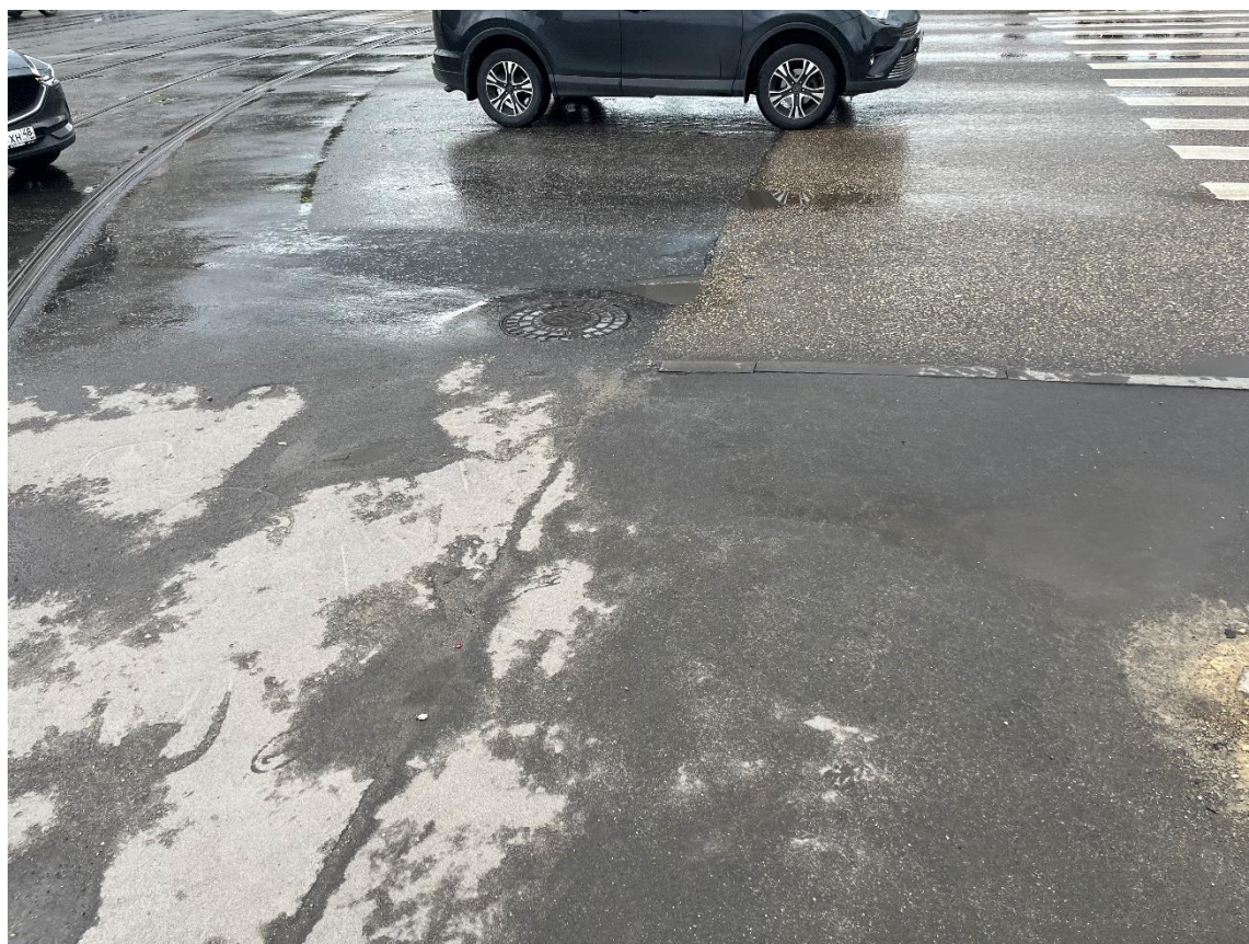
Рис. 53. Просадка канализационного люка, обустроенного подрядчиком Концессионера на пересечении пр. 60 лет СССР и ул. Меркулова
