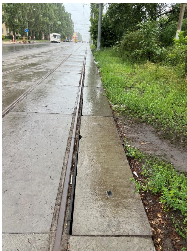
Рис. 35. При подготовке к запуску движения необходимо устранить засорение трамвайного пути и устранить смещение краевых плит по ул. Краснозаводская
