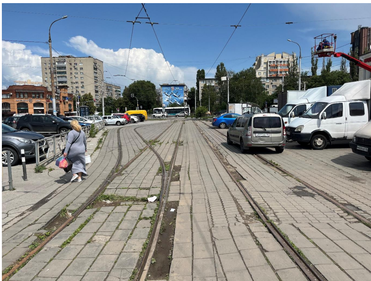
Рис. 81. Демонтаж трамвайного разворотного кольца в районе Центрального рынка на момент проведения Проверки не осуществлён.
