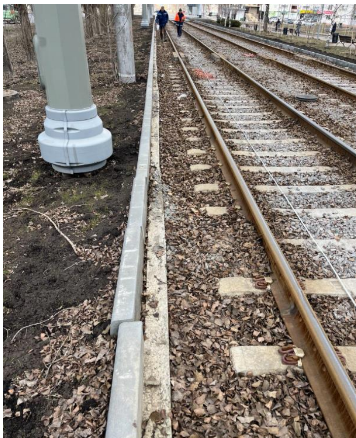
Рис.60. Неплотное примыкание бортового камня остановка «Березовая Аллея»
