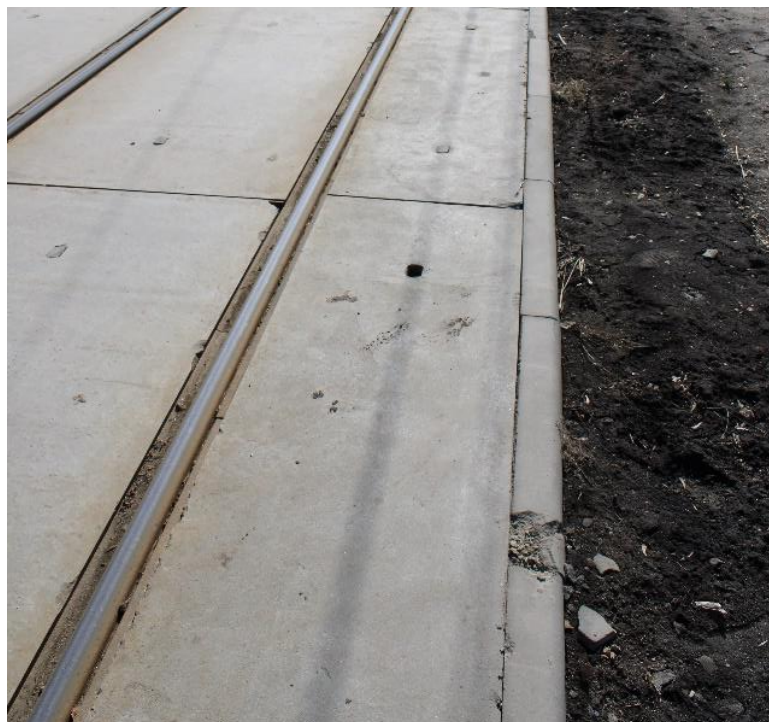
Рис. 66. Повреждение бортового камня на остановочном пункте «Улица Полиграфическая»
