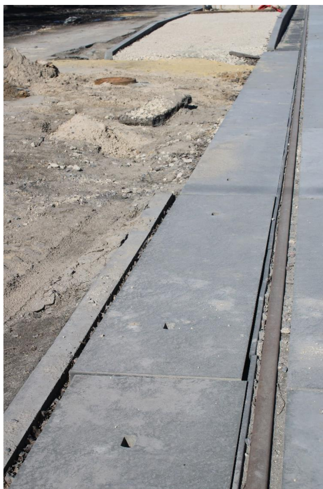
Рис. 39. Смещение плиты в районе остановочного пункта «Улица Краснозаводская»
