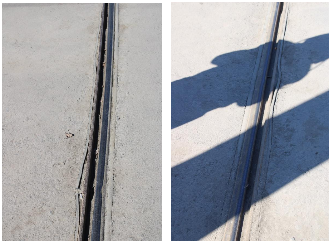
Рис. 55. Неплотное прилегание промежуточного уплотнения между рельсами и асфальтным покрытием остановочный пункт «Октябрьский рынок».
