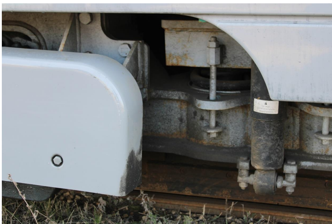
Рис. 3. Следы течи масла вследствие трещины редуктора 1 колесной пары вагона № 332 и коррозия первой моторной тележки.
