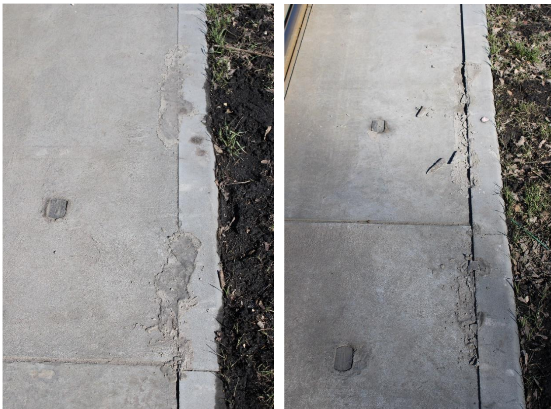
Рис. 63. Повреждение плит и бортовых камней, уложенных в районе остановочного пункта «Парк Победы»
