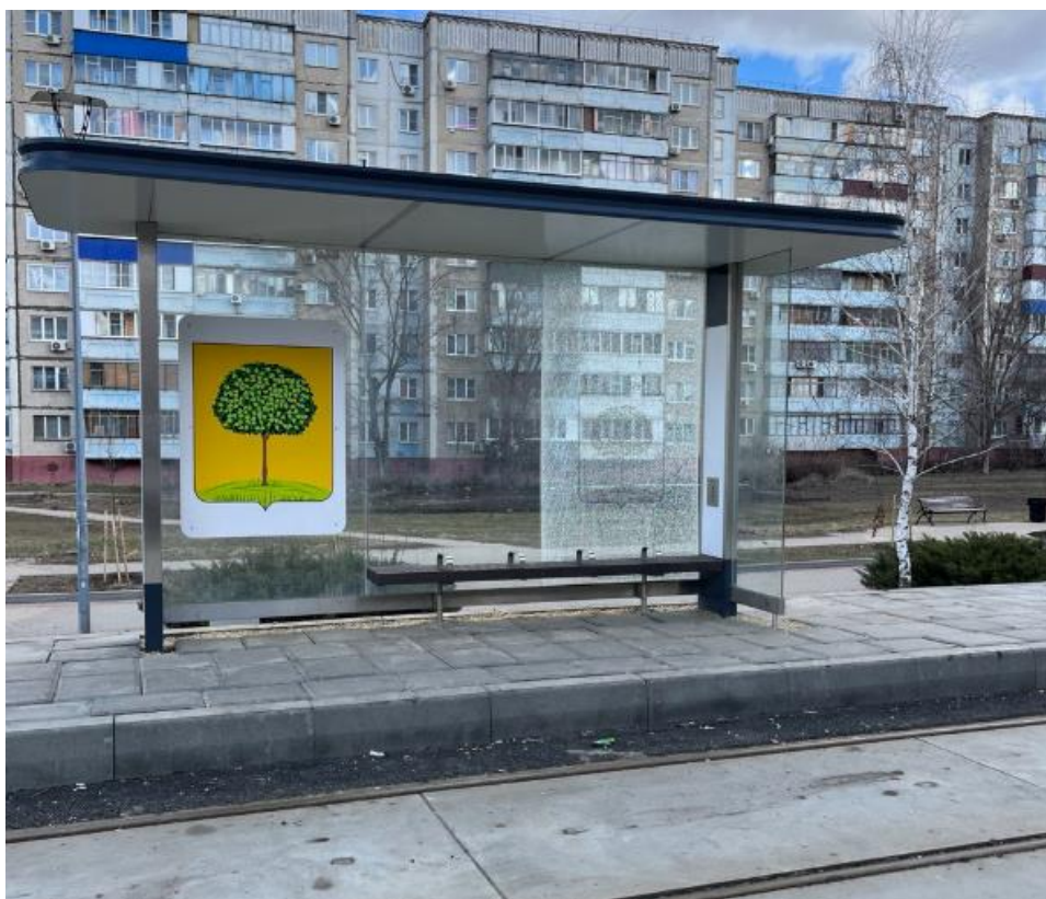
Рис.59. Стеклопанель остановочного павильона «Березовая Аллея» в сетке трещин
