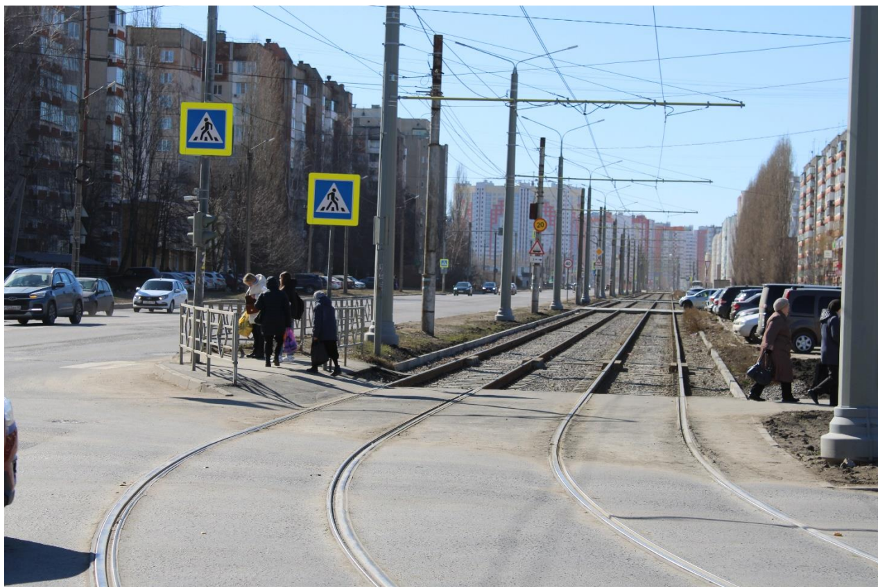
Рис. 56. Пересечение пр. 60 лет СССР и ул. Меркулова. Необходимо переустройство асфальтового покрытия пешеходного перехода во избежание повреждения нижних частей вагона в зимнее время
