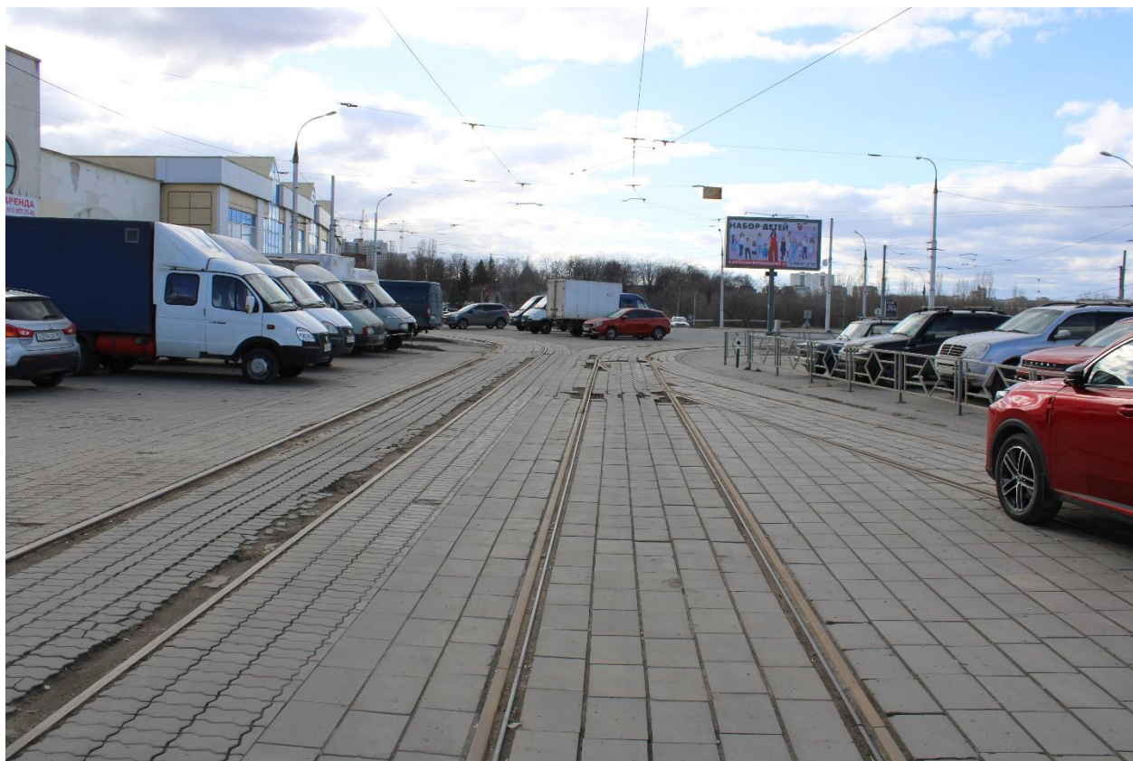
Рис. 84. Демонтаж трамвайного разворотного кольца в районе Центрального рынка на момент проведения Проверки не осуществлён.
