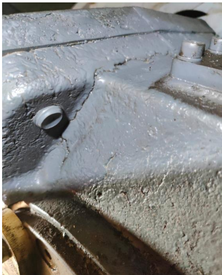
Рис. 2. Трещина редуктора 1 колесной пары вагона № 332 на момент проведения Проверки.
