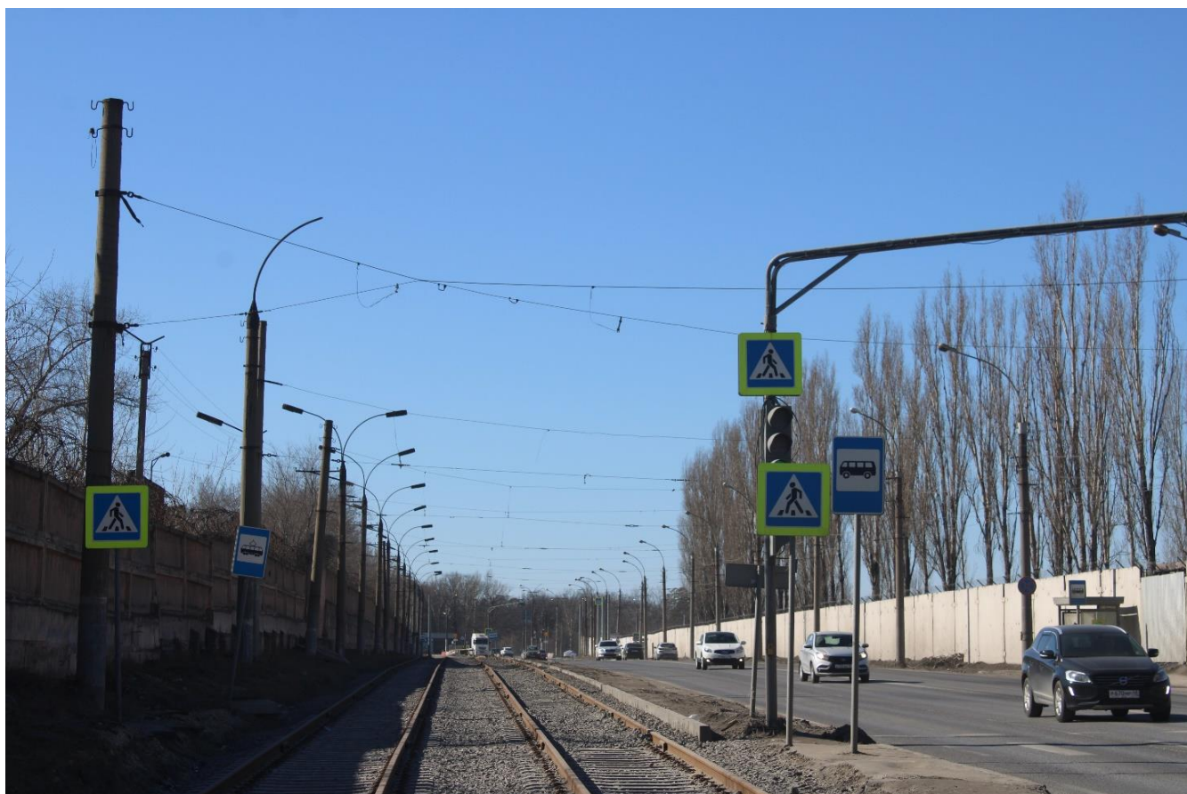
Рис. 87. Общий вид новой уложенной РШР по ул. Metallургов. Растяжки и опоры старой контактной сети не демонтированы
