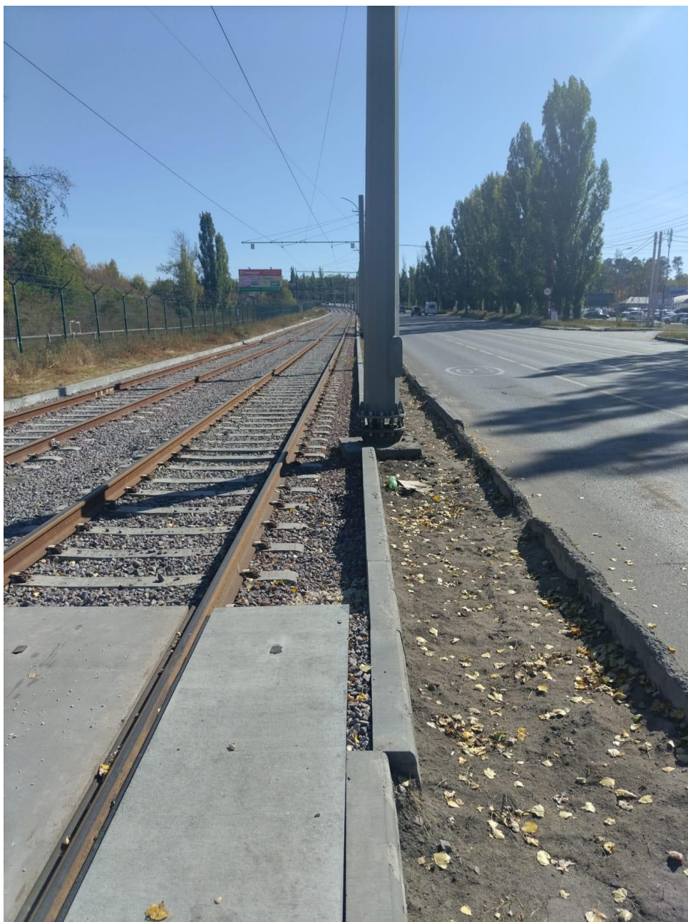
Рис. 102. Неровное примыкание бортовых камней в районе остановочного пункта «ул. Речная». Целесообразно проверить выполненные работы на соответствие проектной документации в части расположения опор и бортовых камней относительно друг друга.
