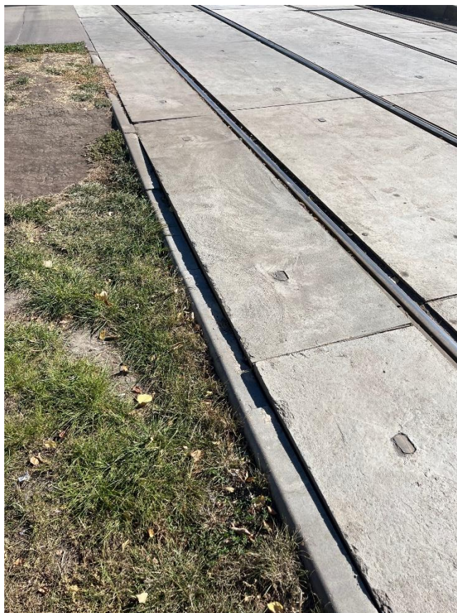
Рис. 64. Просадка бордюрного камня в районе остановочного пункта «Березовая аллея»
