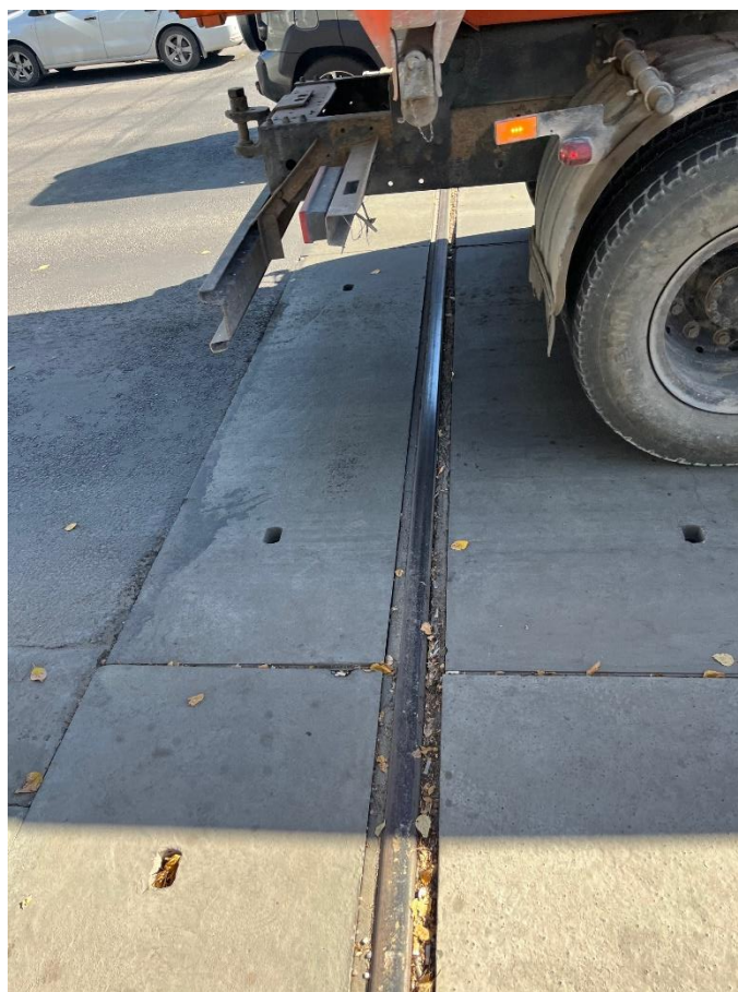
Рис. 112. Подвижность плит, уложенных на пересечении трамвайных путей с проспектом Победы, при проезде тяжелой техники.
