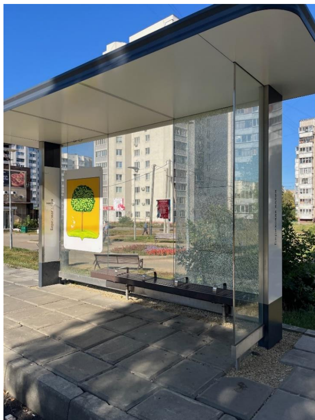
Рис.62. Стеклопанель остановочного павильона «Березовая Аллея» в сетке трещин
