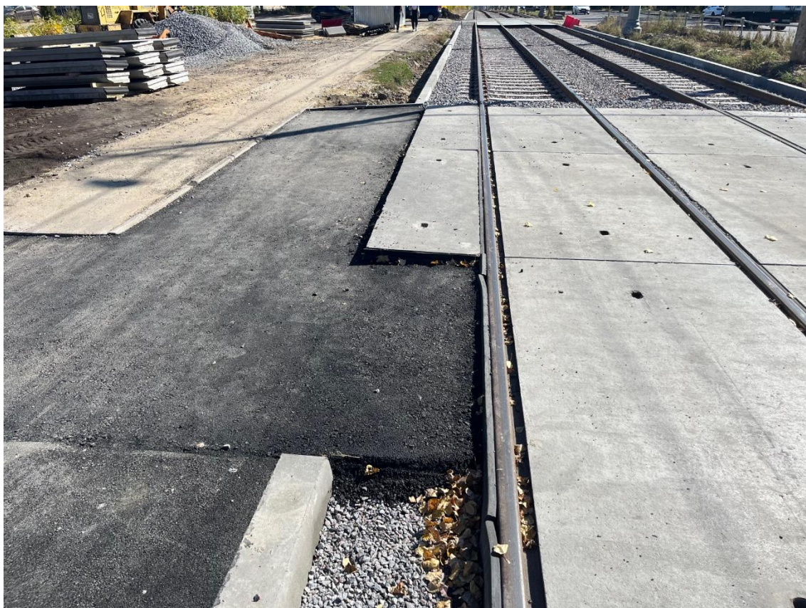
Рис. 107. Просадка краевых плит на остановочном пункте «Село Сырское»
