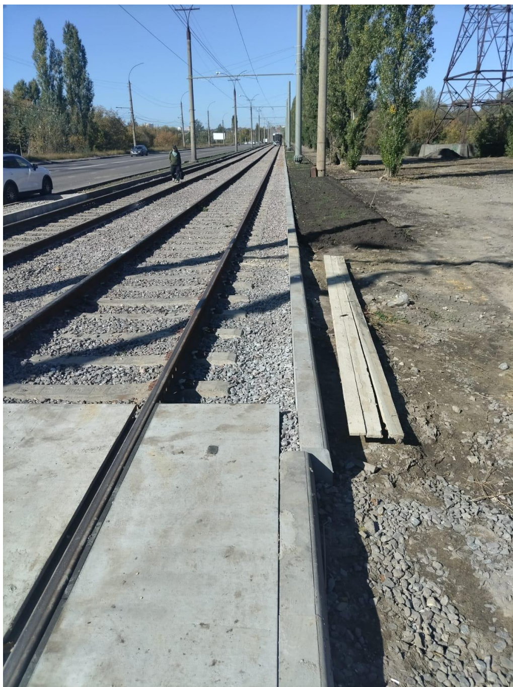
Рис. 104. Неровное примыкание бортовых камней в районе остановочного пункта «ул. Речная». Целесообразно проверить выполненные работы на соответствие проектной документации.
