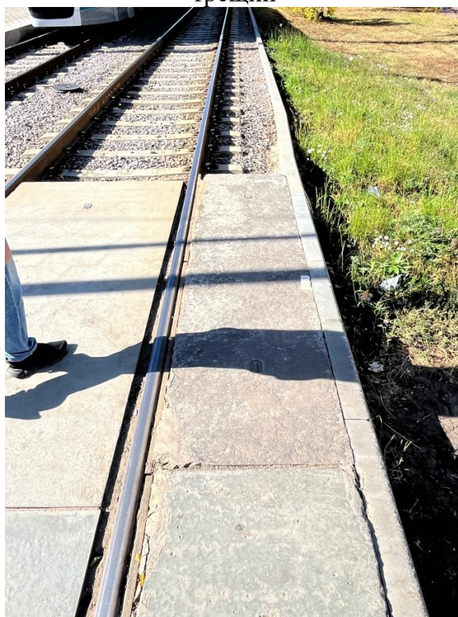
Рис.63. Повреждение плит, уложенных в районе остановочного пункта «Березовая Аллея»
