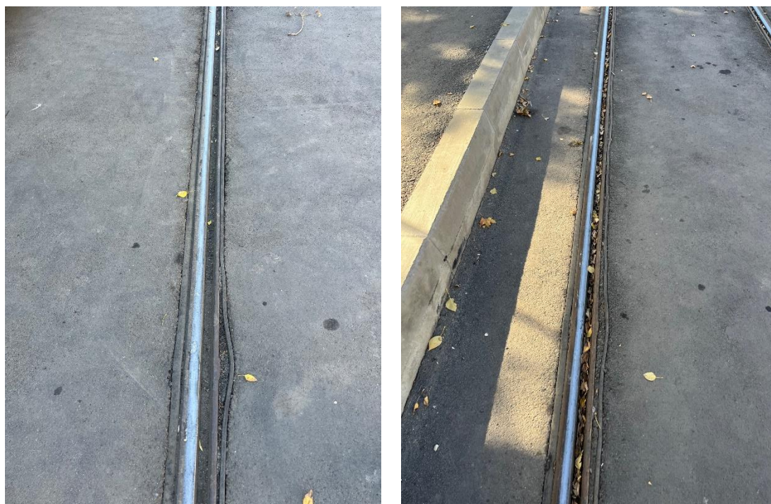
Рис. 53. Неплотное прилегание промежуточного уплотнения между рельсами и асфальтным покрытием остановочный пункт «21 микрорайон».
