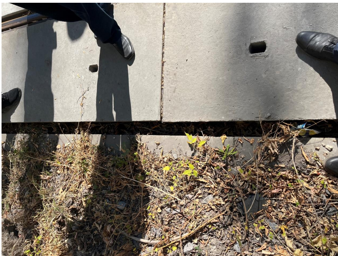
Рис. 30. Неплотное прилегание краевых плит к бордюру на остановочном пункте «3-е Сентября»
