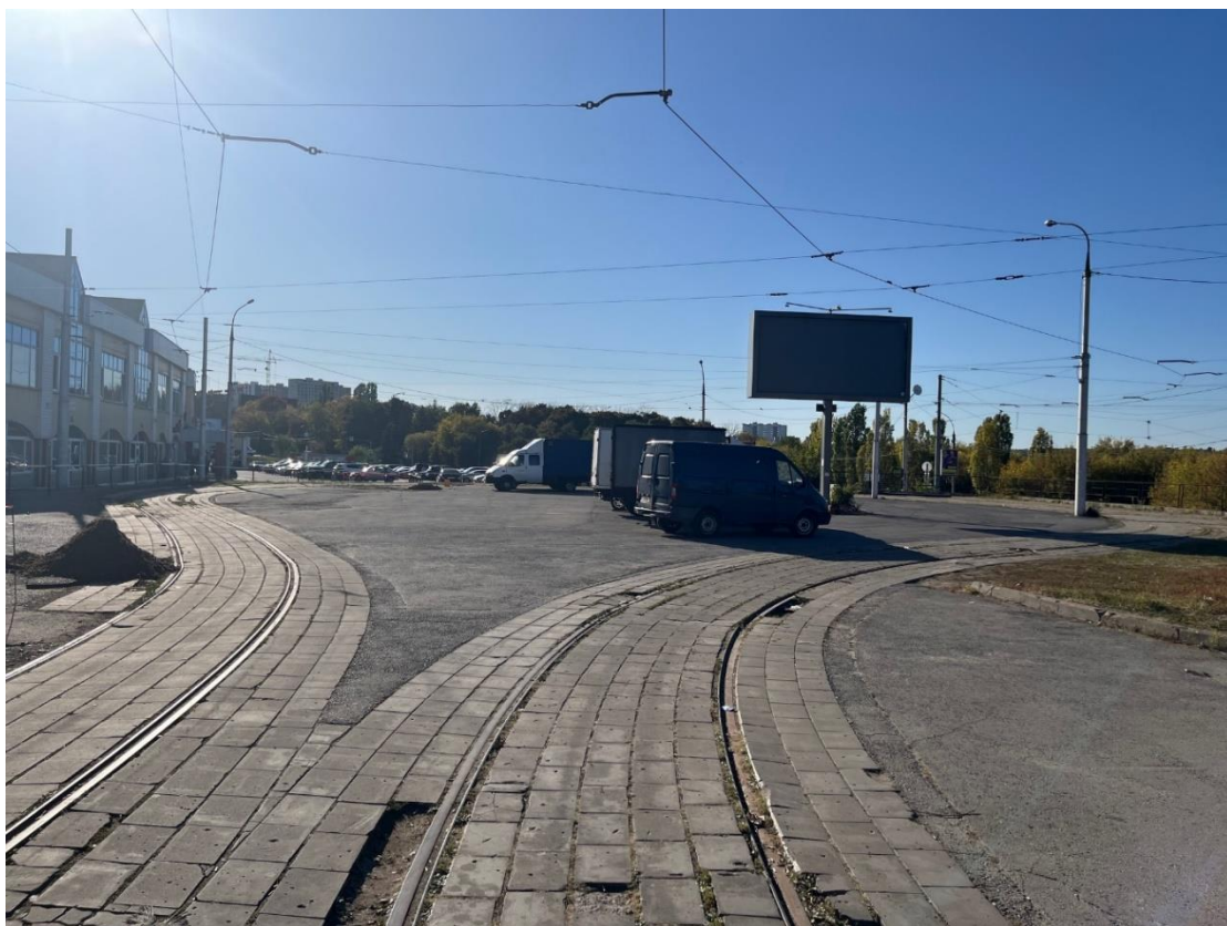
Рис. 84. Демонтаж трамвайного разворотного кольца в районе Центрального рынка на момент проведения Проверки не осуществлён.
