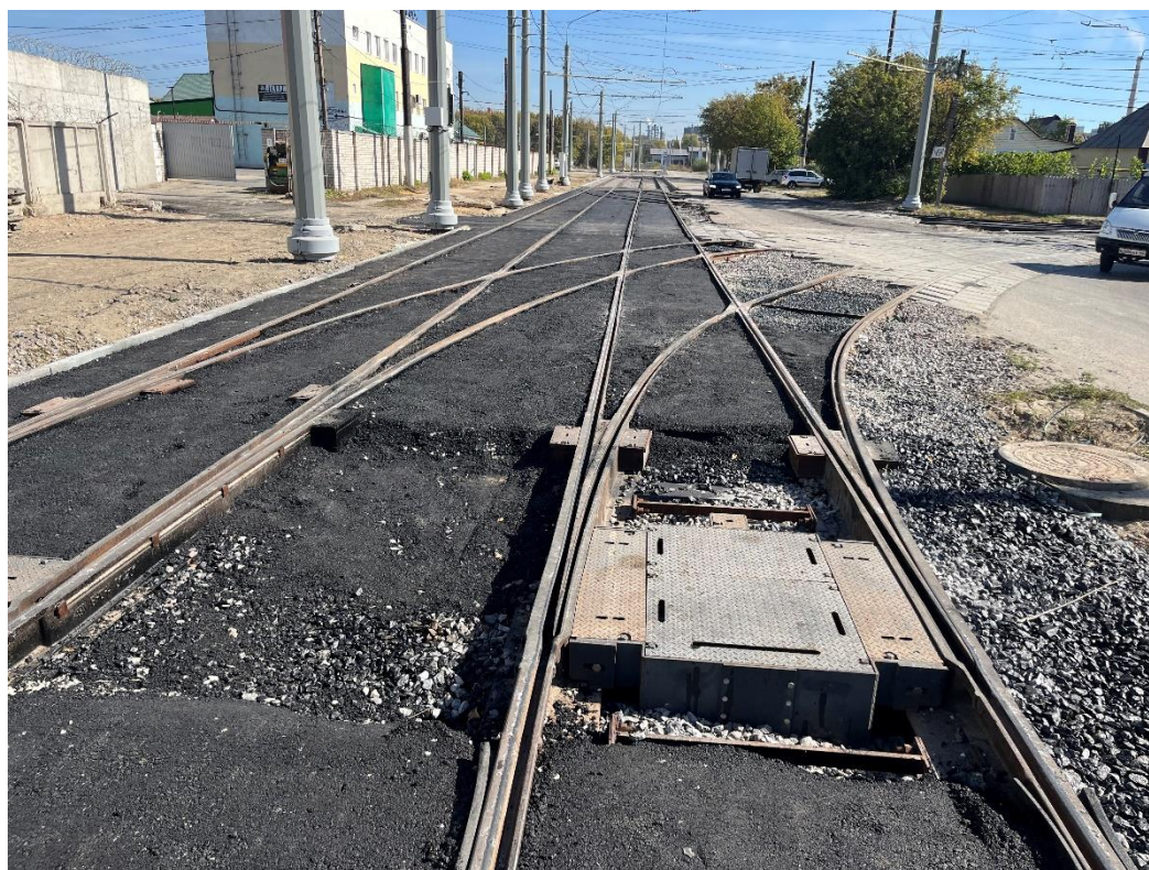
Рис. 26. Стрелочный перевод по ул. 3 Сентября не работает в автоматическом режиме
