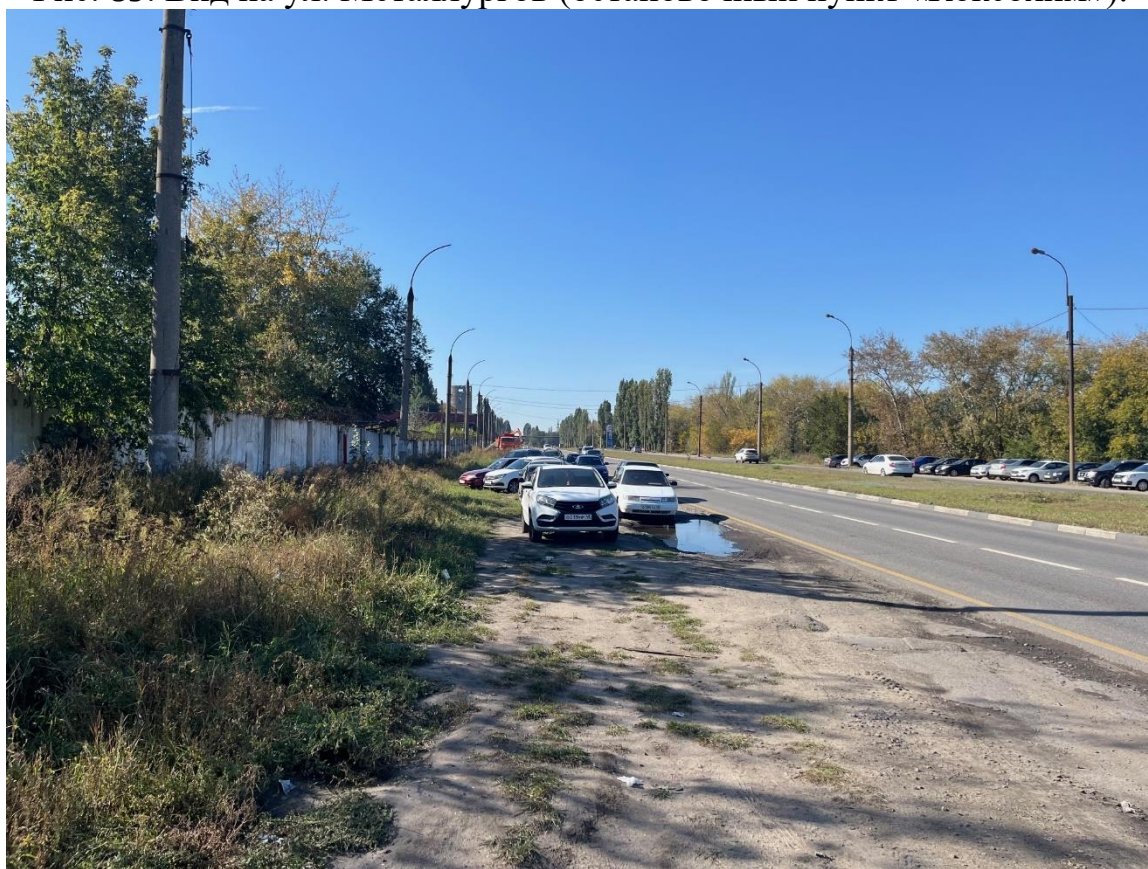
Рис. 90. Ул. Metallургов не в полном объеме демонтированы элементы старой контактной сети
