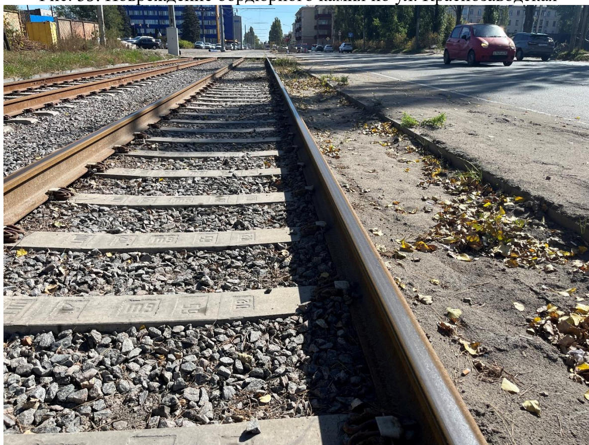
Рис. 40. Засорение балластного слоя открытого трамвайного пути по ул. Краснозаводская
