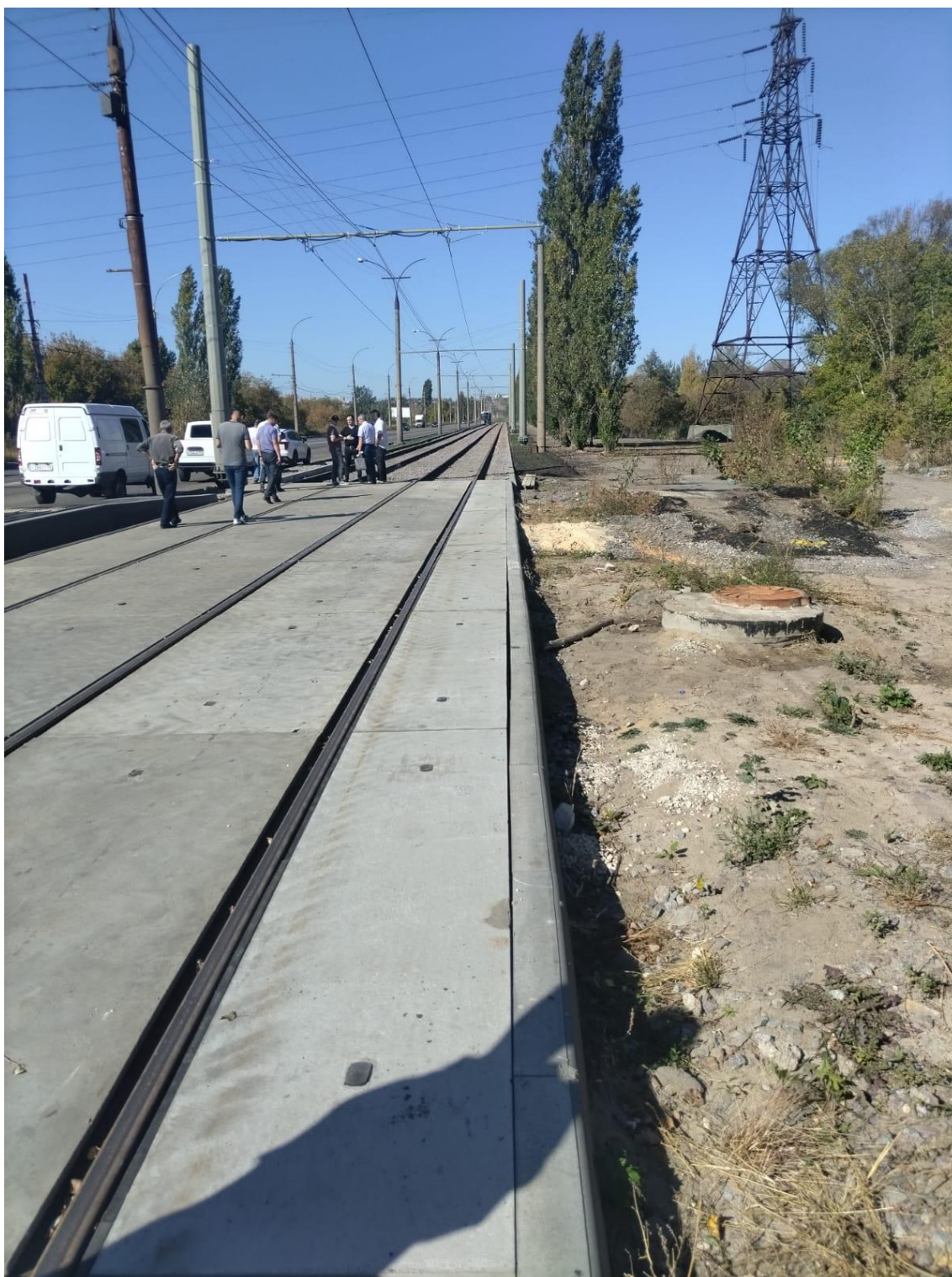
Рис. 103. Неплотное примыкание бортовых камней к краевой плите.
