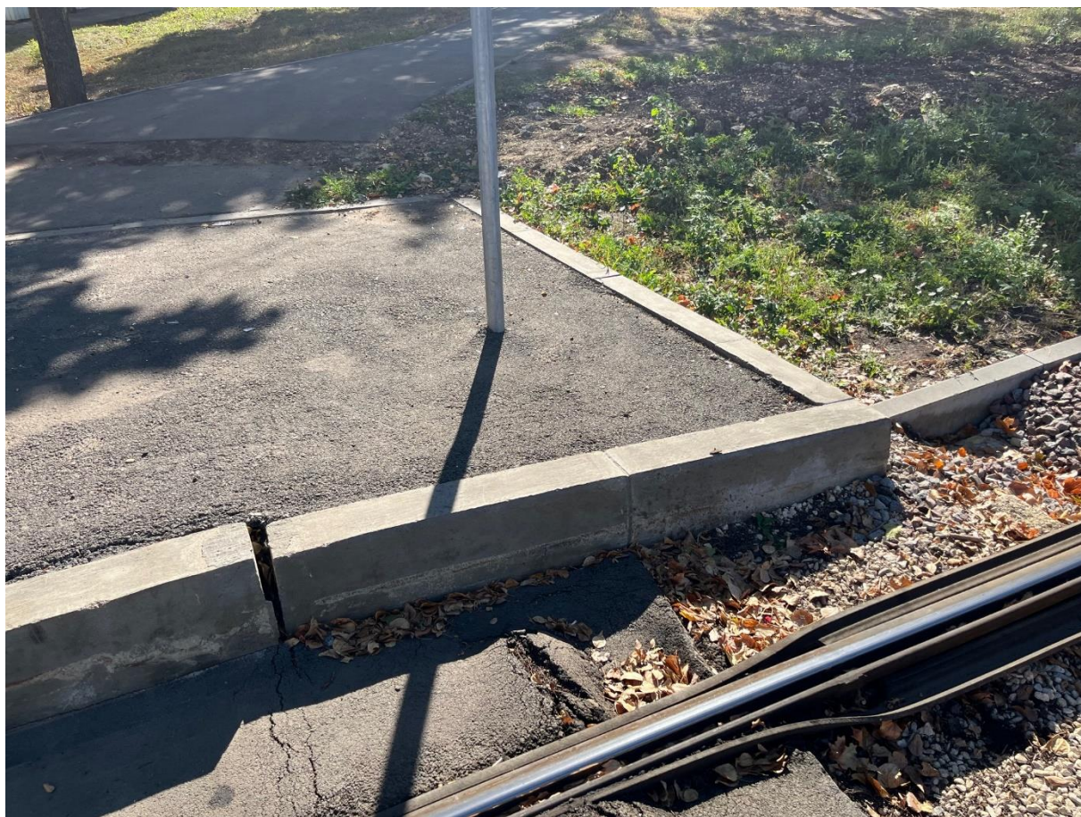
Рис. 54. Просадка грунта в районе посадочной площадки остановочного пункта «21 микрорайон»
