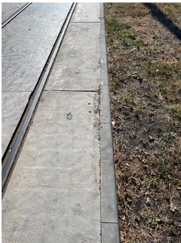
Рис. 68. Повреждение плит и бортовых камней, уложенных в районе остановочного пункта «Парк Победы»
