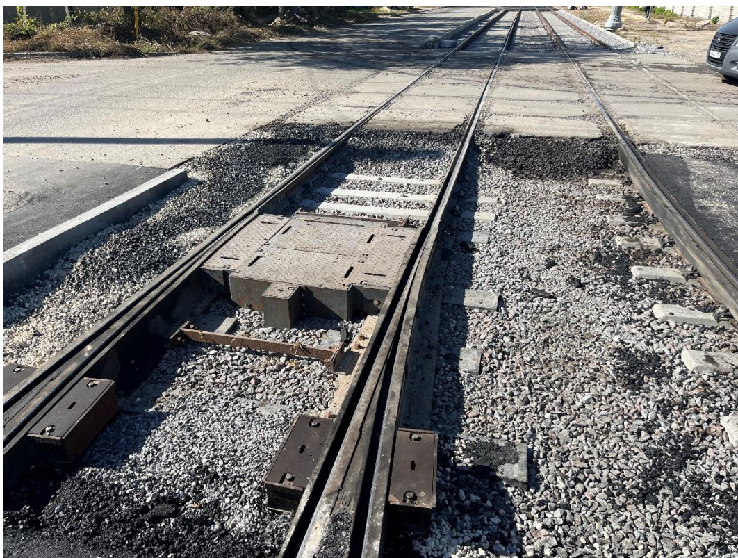
Рис. 19. Стрелочный перевод в районе ул. Чехова не работает в автоматическом режиме
