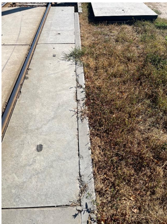
Рис. 70. Повреждение бортового камня на остановочном пункте «Улица Полиграфическая»
