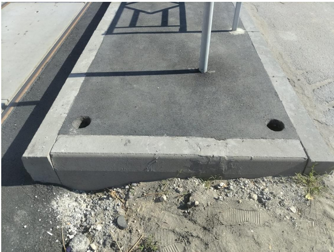
Рис. 25. Повреждённый бортовой камень на остановочном пункте «РСУ»
