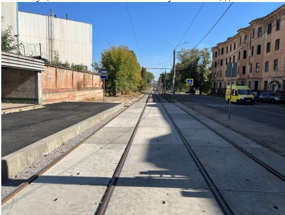
Рис. 32. Текущее состояние остановочного пункта «Площадь Клименкова»
