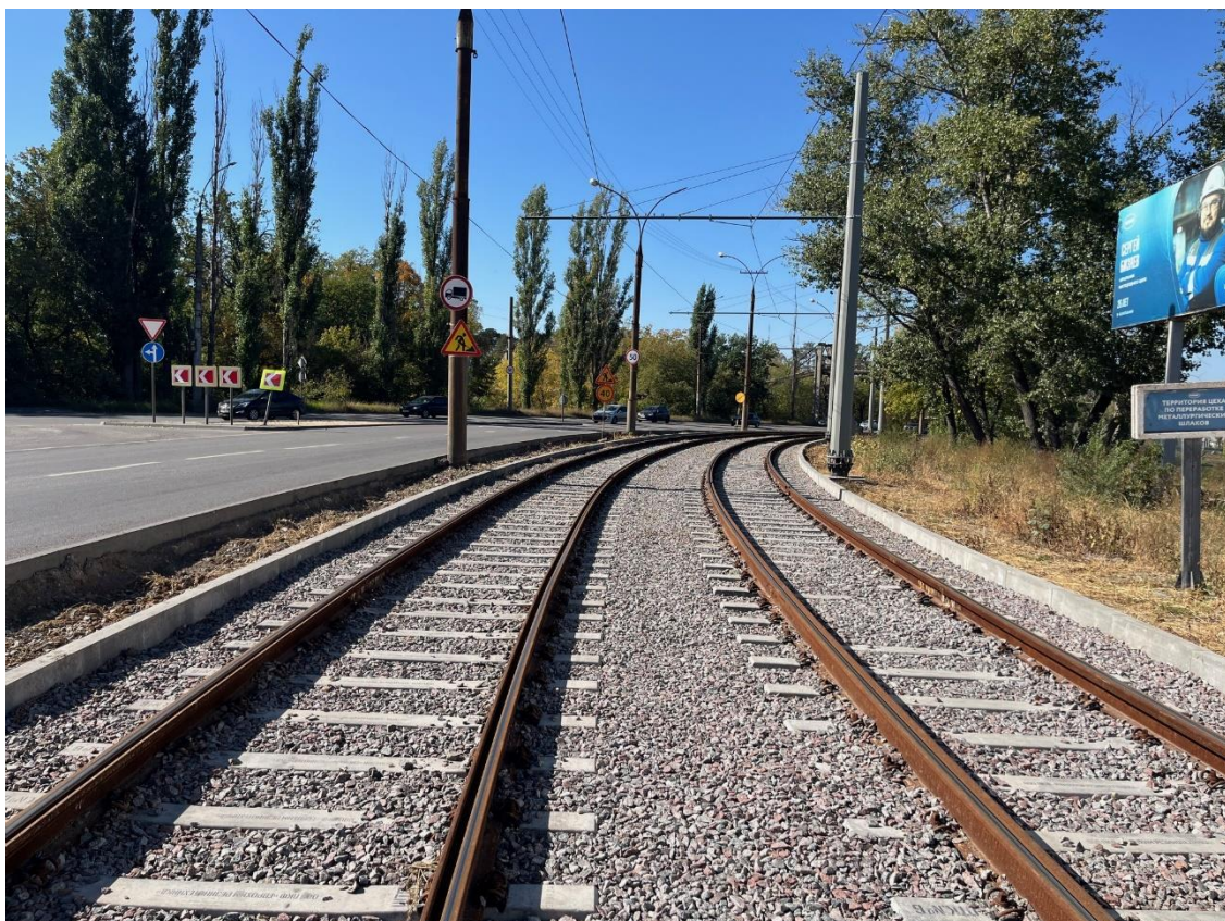
Рис. 97. Прямая рельсовая вставка на кривом участке трамвайного пути в районе кольцевого пересечения ЛТЗ
