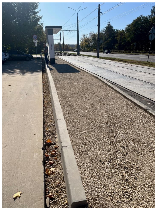
Рис. 67. Переустройство остановочной платформы и перенос павильона на остановочном пункте «Парк Победы». Стеклопанель павильона в сетке трещин.
