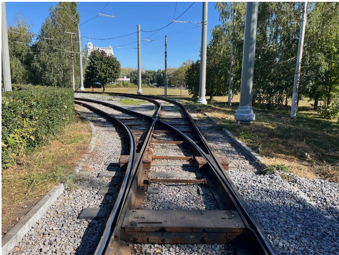
Рис. 52. Разворотный круг на 21 микрорайоне. Стрелочный перевод не работает в автоматическом режиме.
