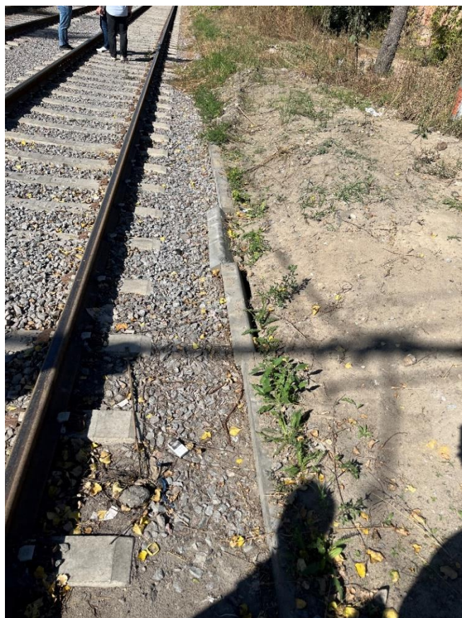
Рис. 39. Повреждение бордюрного камня по ул. Краснозаводская
