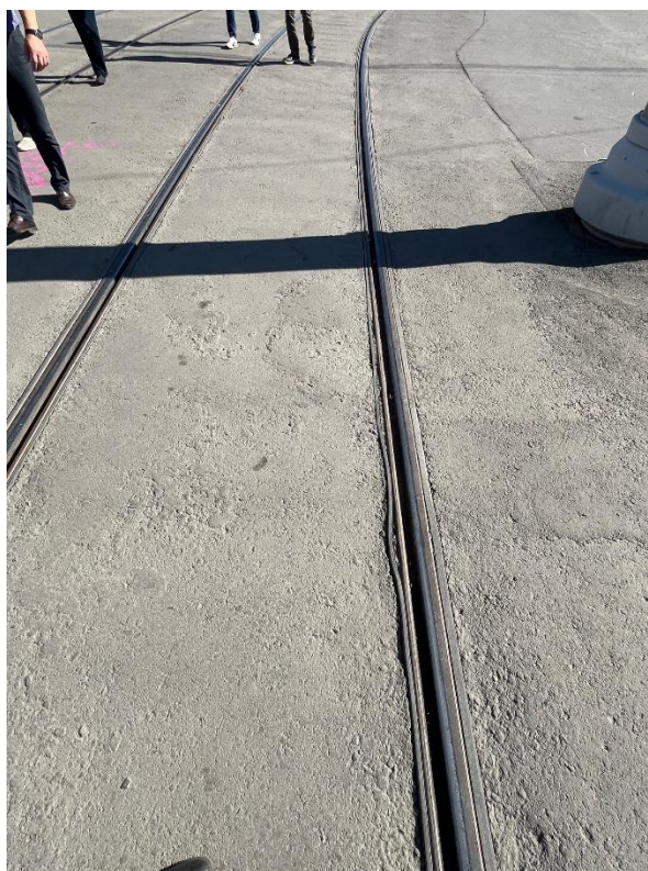
Рис. 57. Неплотное прилегание промежуточного уплотнения между рельсами и асфальтным покрытием остановочный пункт «Октябрьский рынок».
