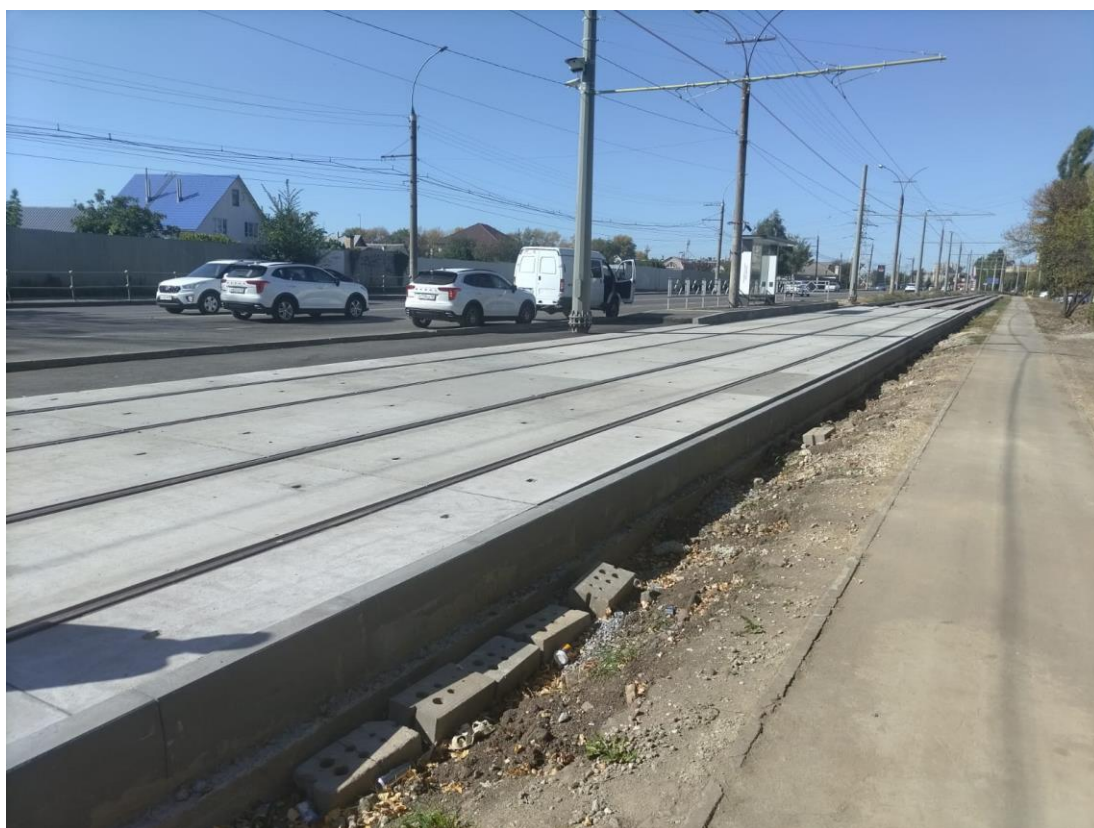
Рис. 108. Просадка бортовых камней относительно краевых плит в районе остановочного пункта «Село Сырское».
